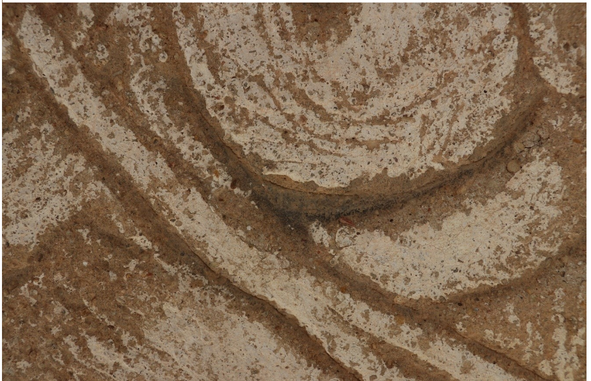
Obrázek 8 Detail defektu- černé depozity
