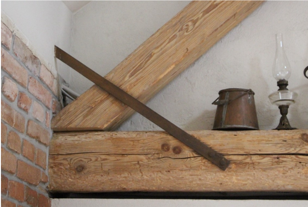
Obr. 51: Železné táhlo ztužující příčnou vazbu
