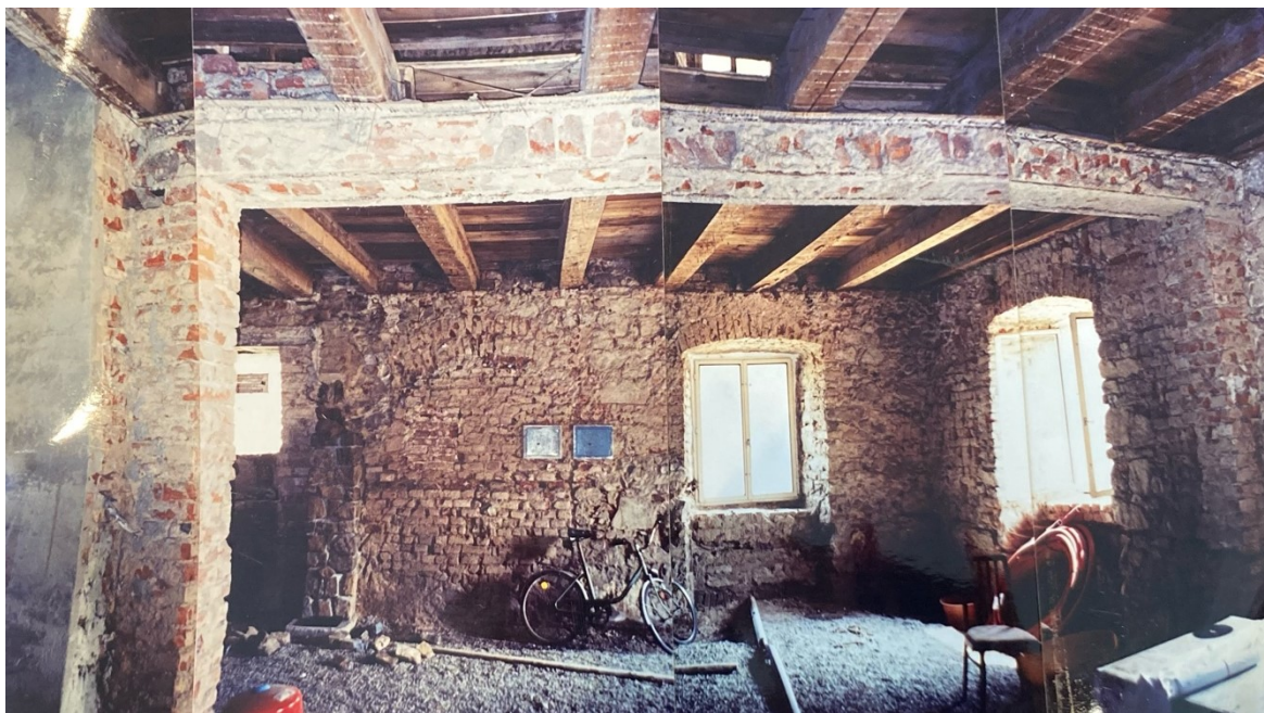
Obr. 62: Sekvence posleповaných fotografií – přízemí, obytná část (patrný klenební pas v místě nad kolem – pravděpodobně od pece)
