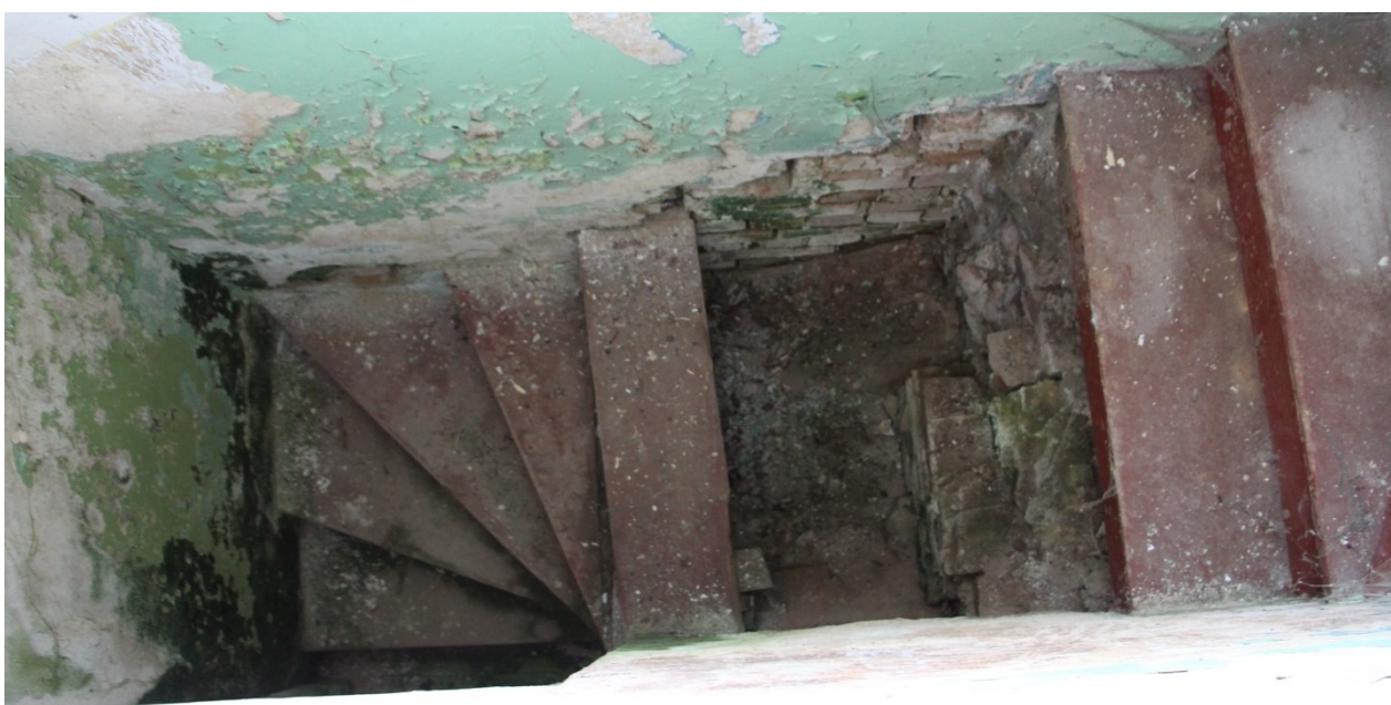
Obr. 109: Rozbité schodiště vedoucí z prvního patra do přízemí
