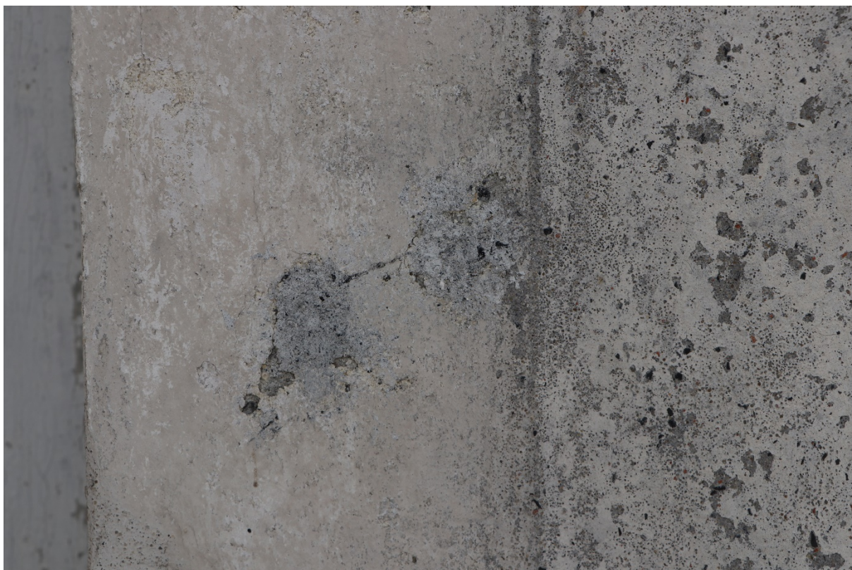
Obrázek 23 Detail zajišťovacích tmelů na špaletě okna. Stav díla před restaurováním.
