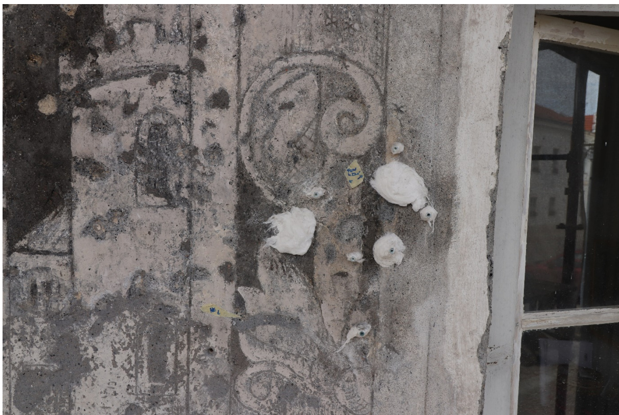
Obrázek 26 Průběh hloubkové injektáže a odstraňování nevyhovujících druhotných tmelů na výjevu s iluzivní architekturou.
