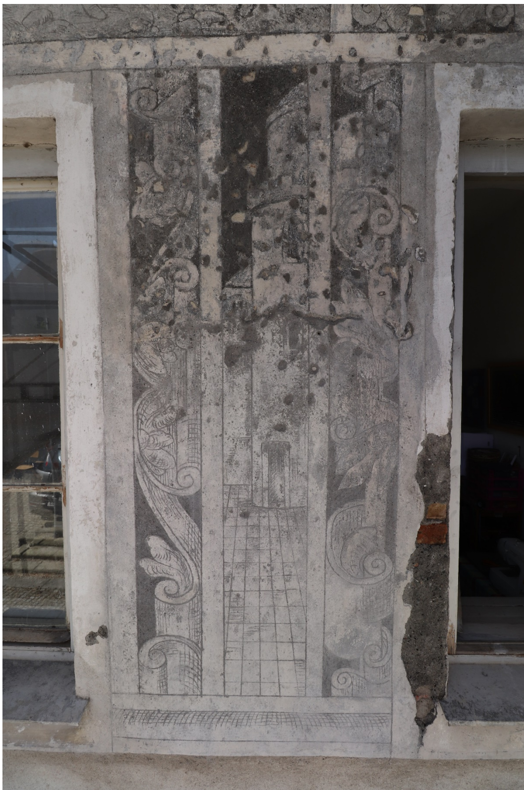
Obrázek 43 Sekvence výjevu s iluzivní architekturou. Stav díla po odstranění nevhovujících druhotných tmelů a konsolidaci otevřených defektů.
