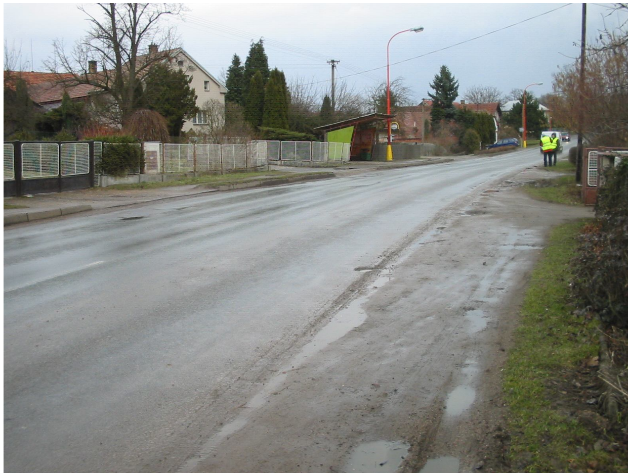
8) Celkový pohled na autobusovou zastávku a stav krajnice (staničení km 0,580-0,630)
