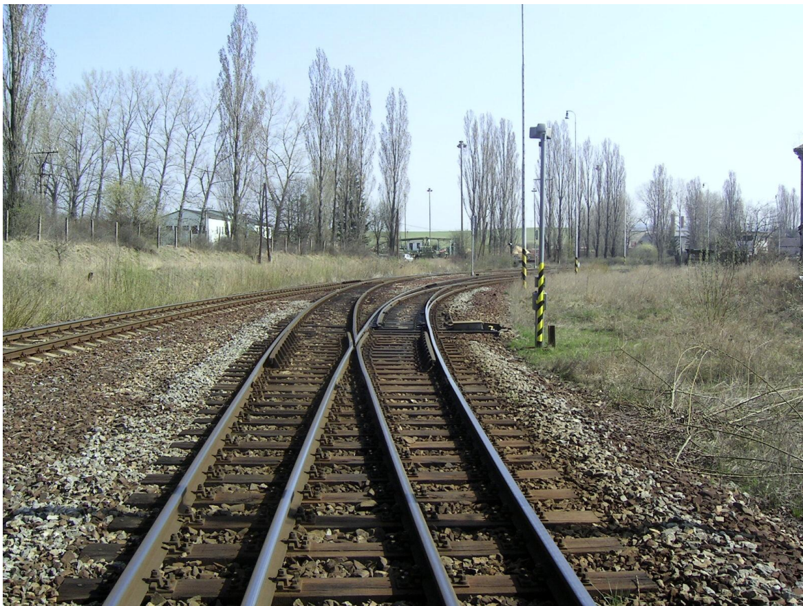
Foto 7 – Spojka mezi KV č. 3 a ZV č. 5
