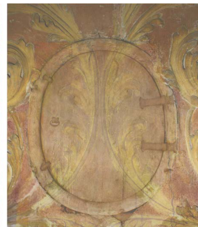
24. Pokus o rekonstrukci původní podoby servisních dvířek – prvek neměl přitahovat pozornost, alterace a míru dochování poměrně choullostivých povrchových úprav negativně ovlivnila četnost používání otvoru a neúdržba střechy nad kupolí
