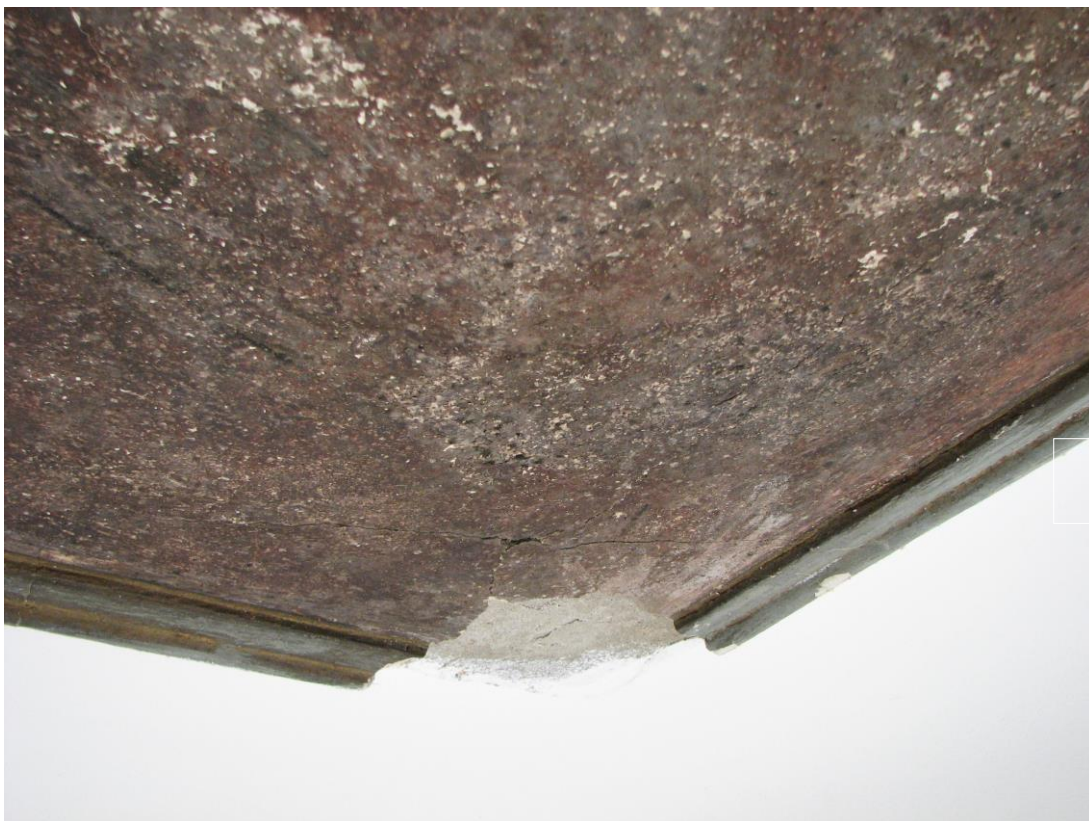
Obr. 11 Poškození štukového rámu včetně chybějící omítkové vrstvy s malbou v rohu obrazu.
