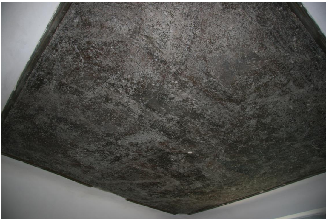
Obr. 1 Celkový pohled na nástropní malbu poškozený plísněmi před zahájením restaurování. Povrch barevné vrstvy pokrývala silná vrstva plísní, která činila malbu nečitelnou.
