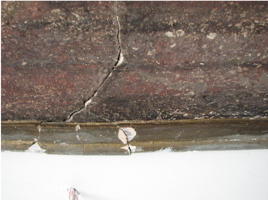
Obr. 10 Detailní foto defektu v ploše obrazu způsobeného statickou trhlinou a zasahujícího přes štukový rám.
