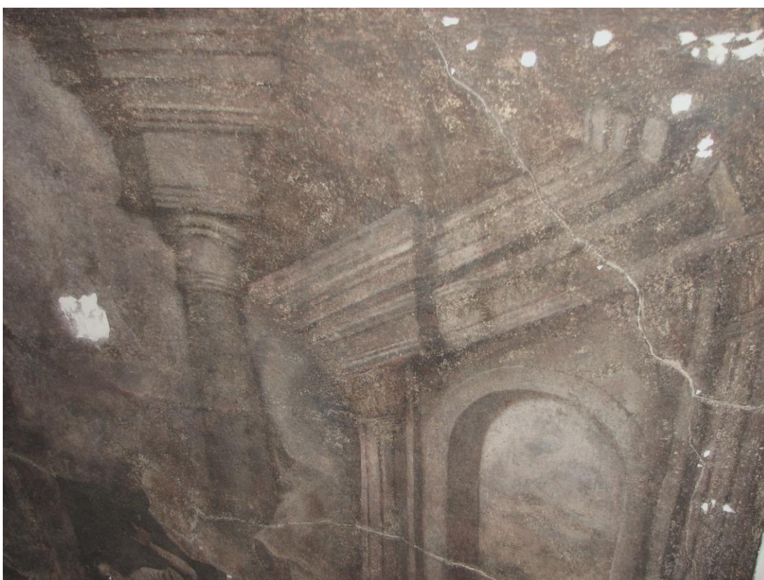
Obr. 23 Malba po vytmelení prasklin a defektů v omítkové vrstvě.
