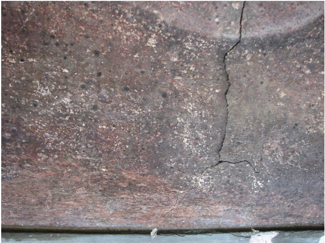
Obr. 9 Prasklina v omítkové vrstvě.
