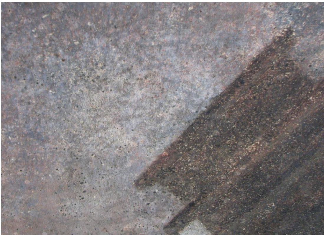
Obr. 13 Detail malby po dočištění a oslabení zbylých reziduí plísní.
