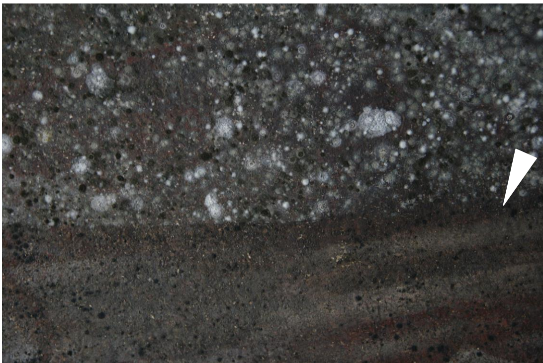
Obr. 5 Zkouška snímání vrstvy plísní z povrchu malby, viz šipka. Zkouška byla provedena destilovanou vodou.
