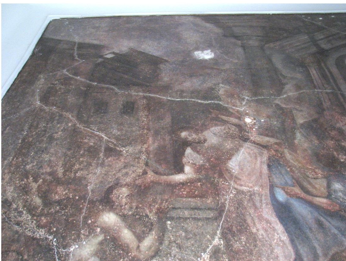
Obr. 22 Malba po vytmelení prasklin a defektů v omítkové vrstvě.
