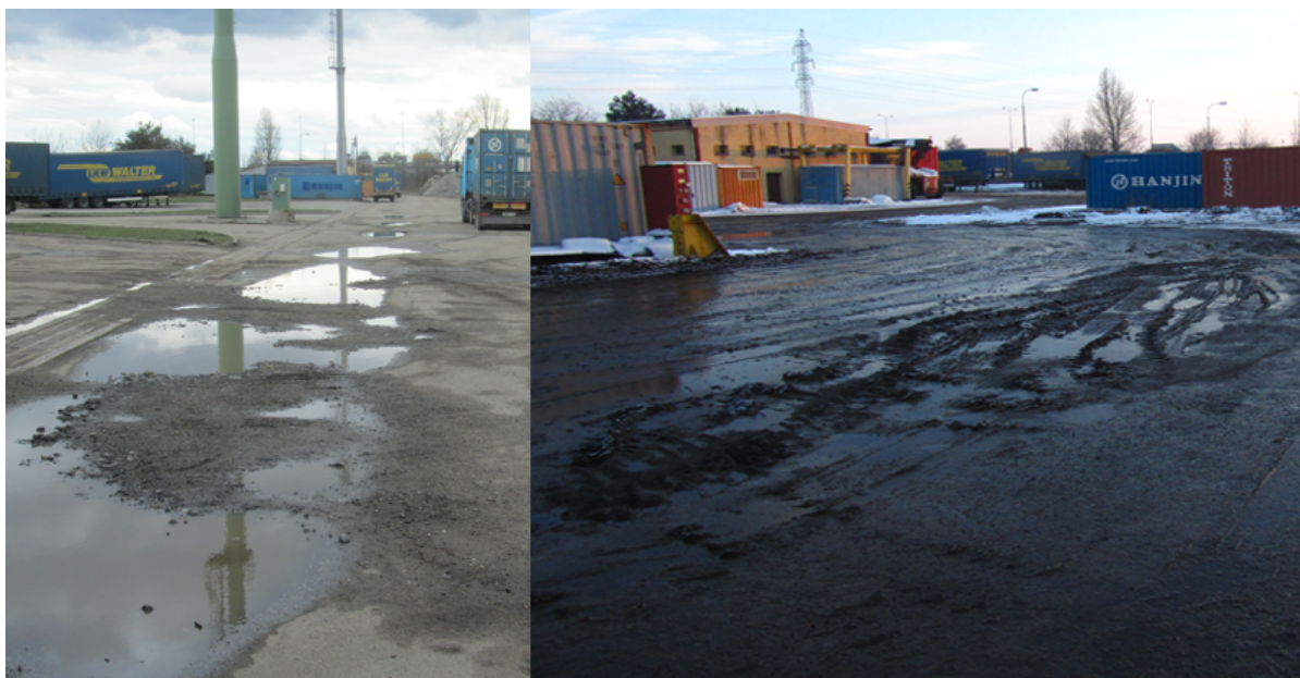
Obrázek 5 Poškozené zpevněné plochy
