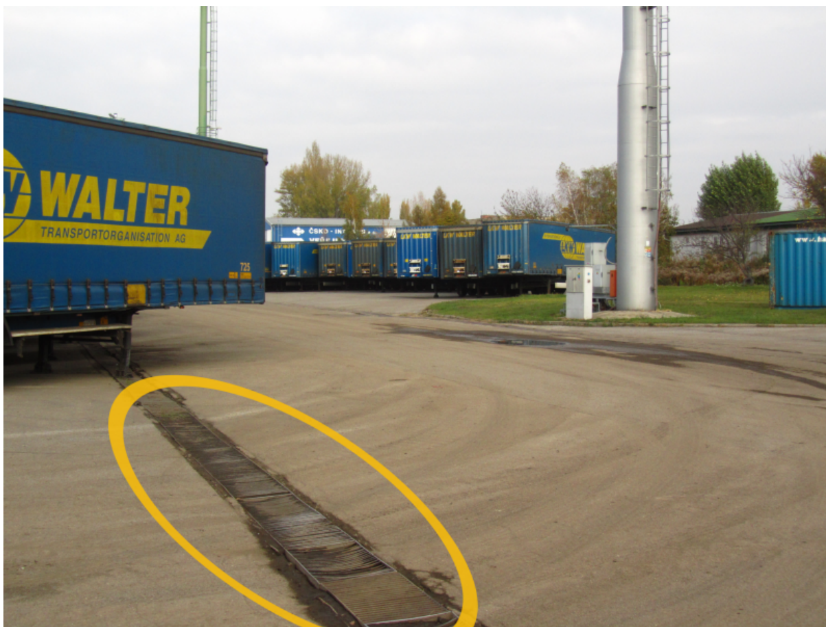
Obrázek 2 Poškozený rošt kanalizace
