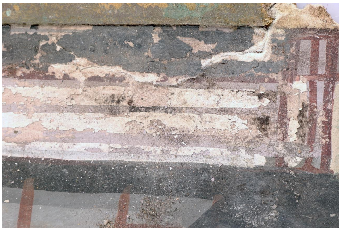
Obr. 103. Stav před restaurováním, detail poškození, denní rozptýlené světlo, lícová strana.
