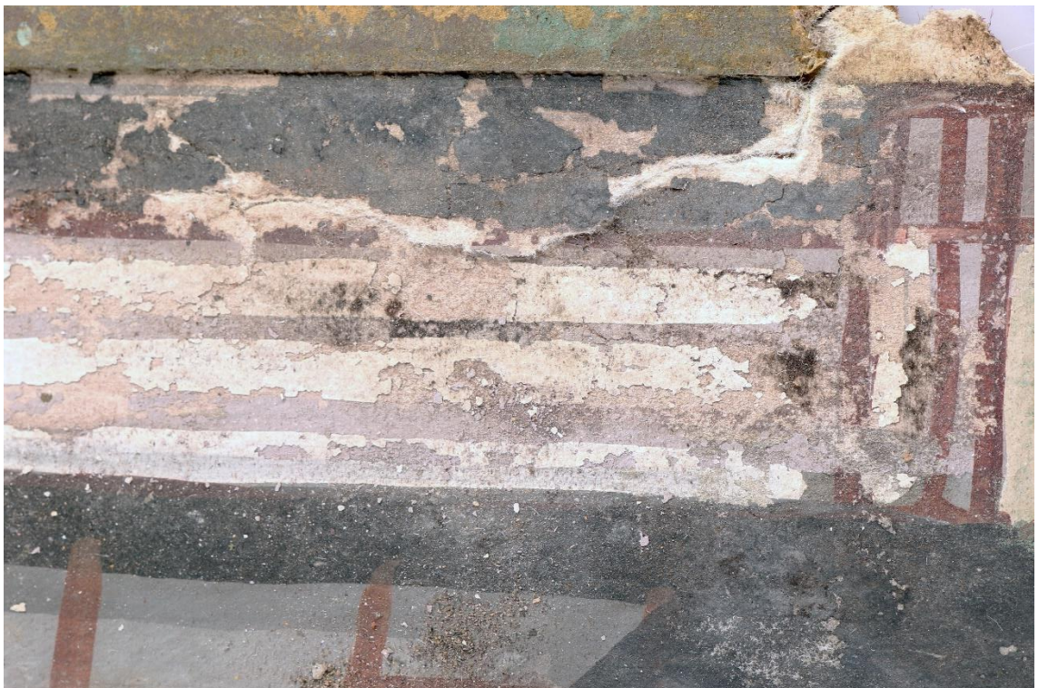
Obr. 66. Stav před restaurováním, detail poškození, denní rozptýlené světlo, lícová strana.
