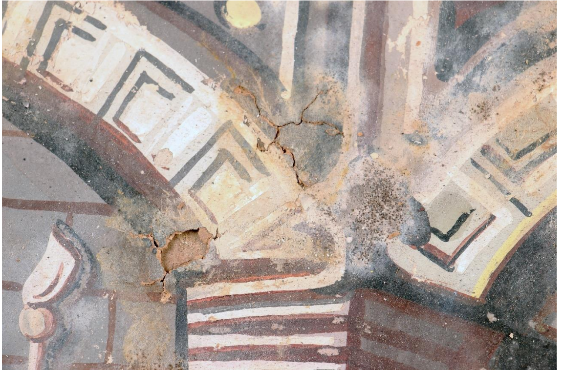
Obr. 97. Stav před restaurováním, detail poškození, denní rozptýlené světlo, lícová strana.
