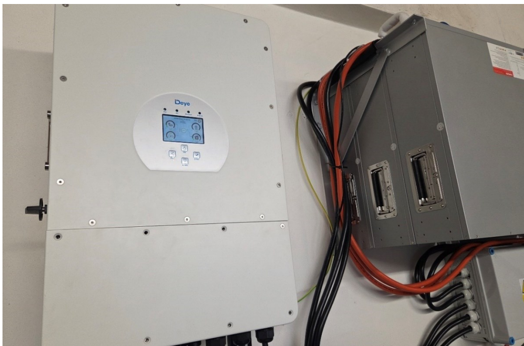
Obrázek 2: Fotovoltaický střídač s bateriemi
