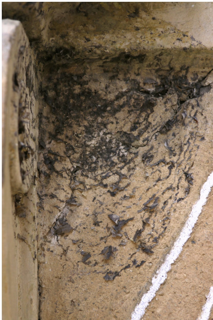
Obr. 22: Ukázka zčernalé síranové krusty v hlubokém prorytí linie – Stav před restaurováním.
