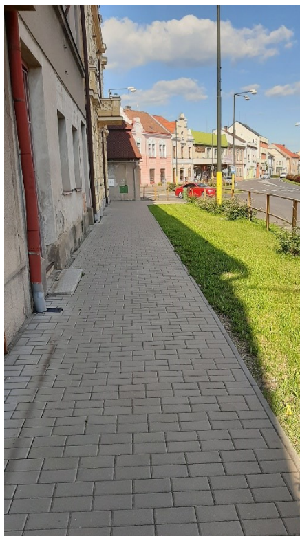
Obr. 26: Chodníková plocha z parketové betonové dlažby západního paprsku ve směru severního paprsku, vzor pokládky 1.
