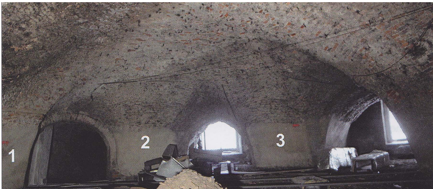
Obr. 38) Giovanni Battista Pieroni?, Velká grotta Valdštejnského paláce, stav v průběhu stavebních prací, detail původní klenby grotty. Praha, Augustiniánský klášter (The Augustine Hotel), 20. léta 17. století. (Čiháková, J. – Müller, M.: Velká grotta Valdštejnského paláce v Praze. In: Průzkumy památek XVI – 2/2009. Praha 2009)
