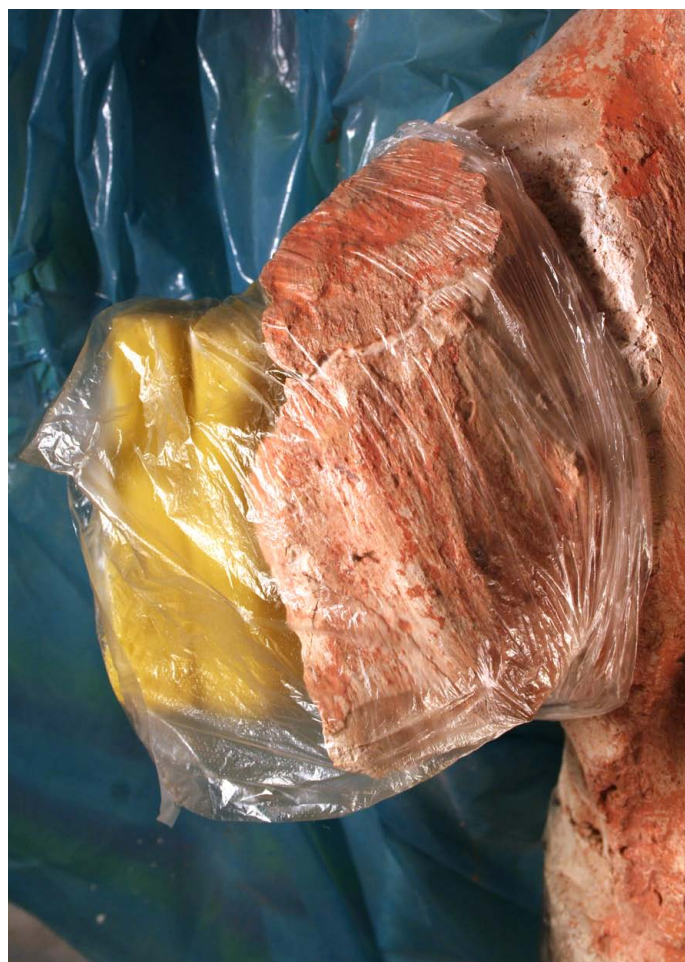
Obr. 182) Udržování vlhkosti na zpevňovaných místech pro lepší vyzrání vápenné nanosuspenze. Hornická grotta, sala terrena, AZ Kroměříž. 1686–1695.
