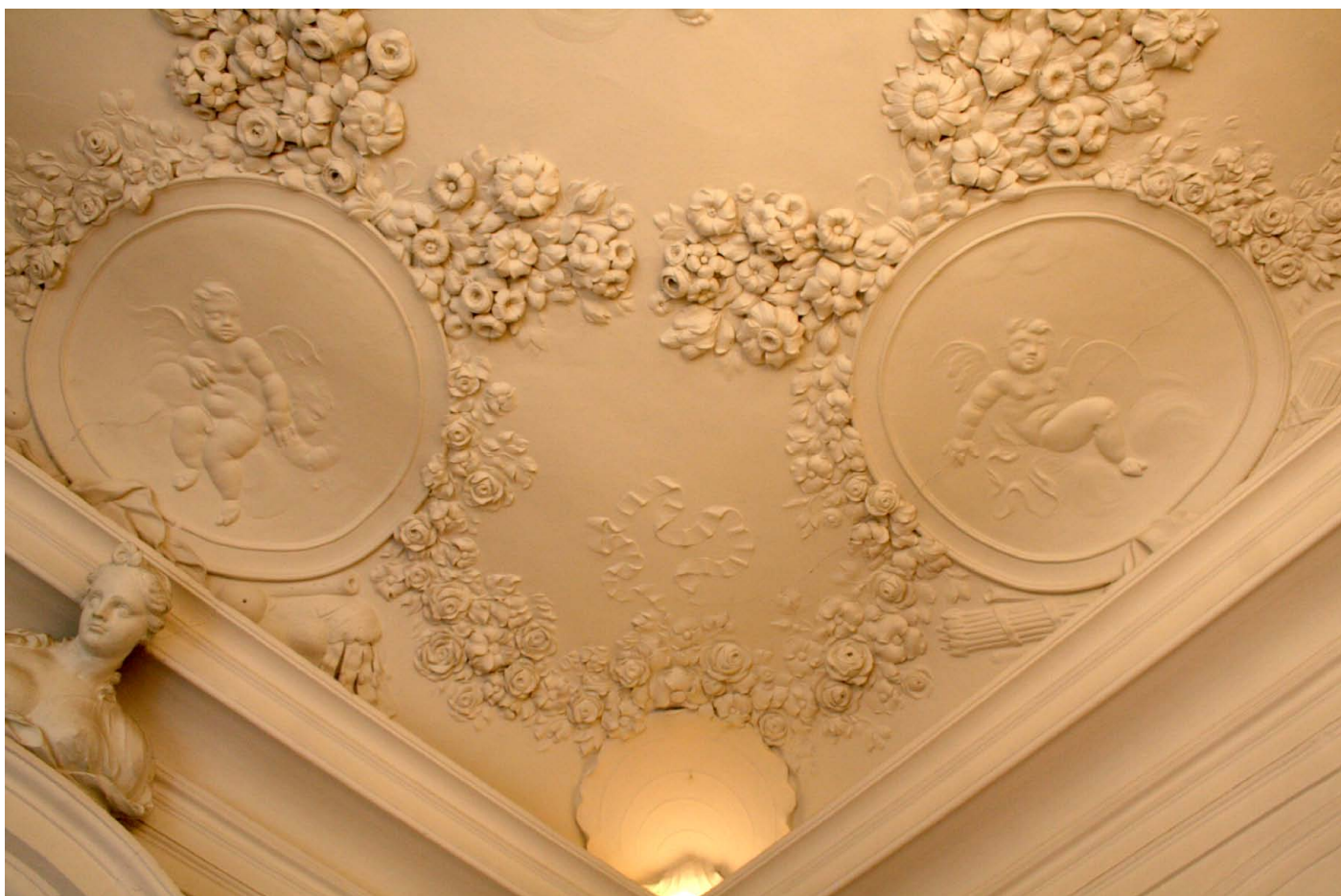
Obr. 93) Baldassare Fontana a jeho dílna, Detail štukové výzdoby s přemalovanou původní barevnou polychromií. Zámek v Polici, bývalá jídelna s krbem. Štuk, 20. léta 18. století.
