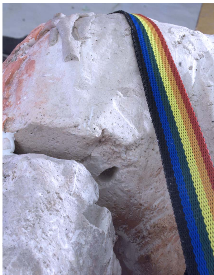
Obr. 174) Navrtnané a vyřezané otvory pro nekovový čep, které se kónicky rozšiřují. Hornická grotta, sala terrena, AZ Kroměříž. 1686–1695.
