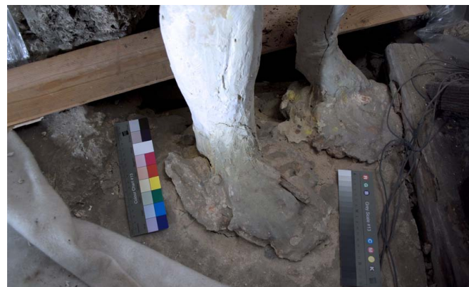
Obr. 155) Jean Baptiste Dieussard, Detail nohou s viditelnými prasklinami ve hmotě štku, nepůvodními sádrovými tmely a otvorem ve skalisku za horníkem (překrytým prknem). Hornická grotta, sala terrena, AZ Kroměříž. 1686–1695.
