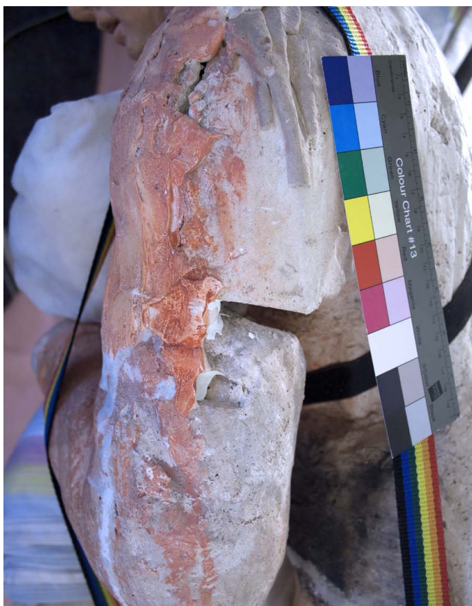
Obr. 173) Detail druhotně upevněné paže po vyjmutí čepu při minulé opravě. Pohledem z boku je dobře patrná velká dutina ve spoji. Hornická grotta, sala terrena, AZ Kroměříž. 1686–1695.
