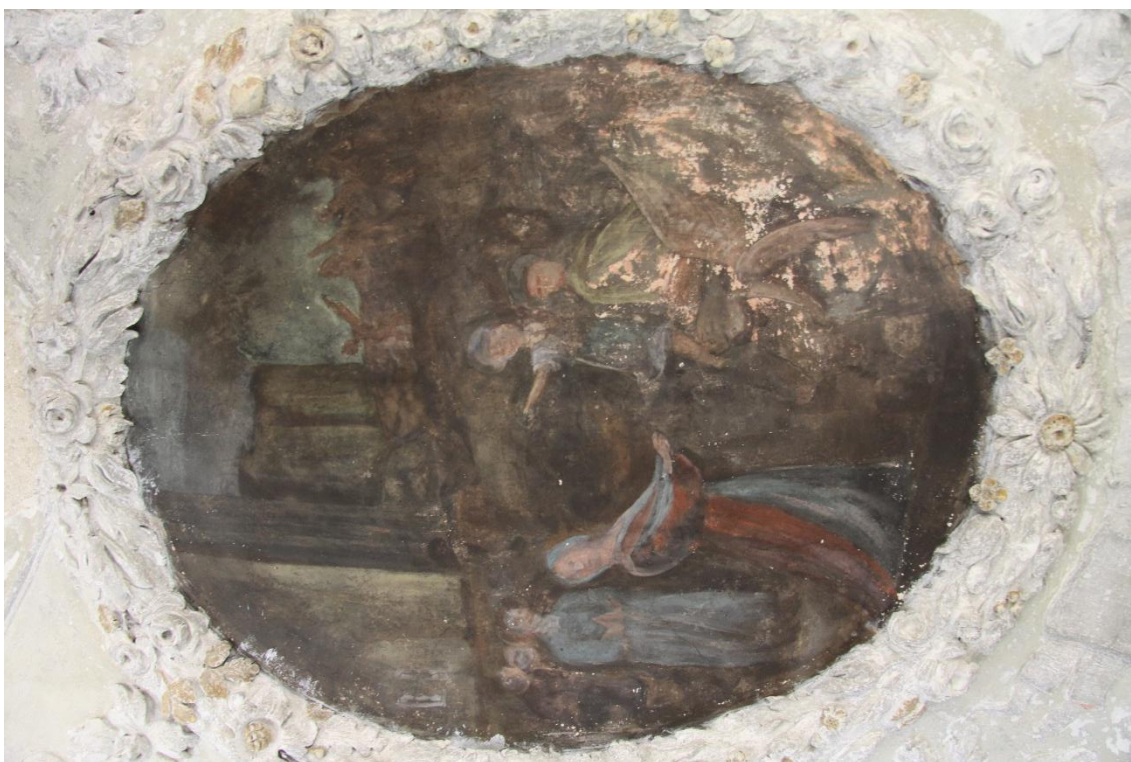
Obr. č. 15 Pohled na centrální výjev. Stav před čištěním pomocí rozpouštědlového gelu.
