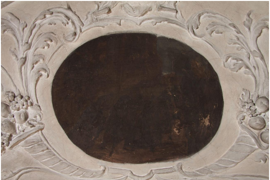
Obr. č. 44 Stav před restaurováním
