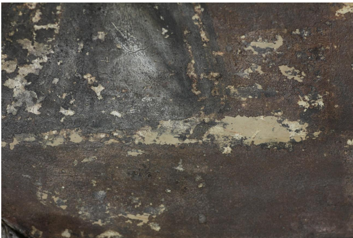
Obr. č. 18 Detail výjevu. Stav po čištění a tmelení probarveným jemným tmelem, jenž byl přizpůsoben barevnosti podkladu.
