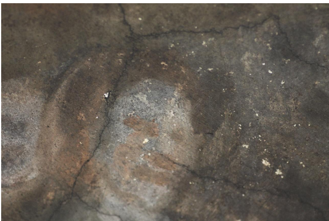
Obr. č. 7 Pravá dolní část výjevu, detail poškození, na malbě pozorujeme praskliny omítky a přemalbu. Stav před restaurováním
