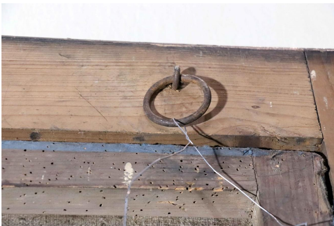
Obr. 192: Stav před restaurováním, detail poškození, napínací rám je napaden aktivním dřevokazným hmyzem.
