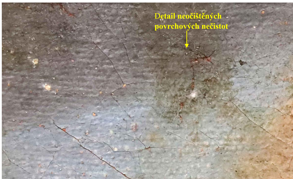
Obr. 54: Zkouška čištění, detail povrchových nečistot.
