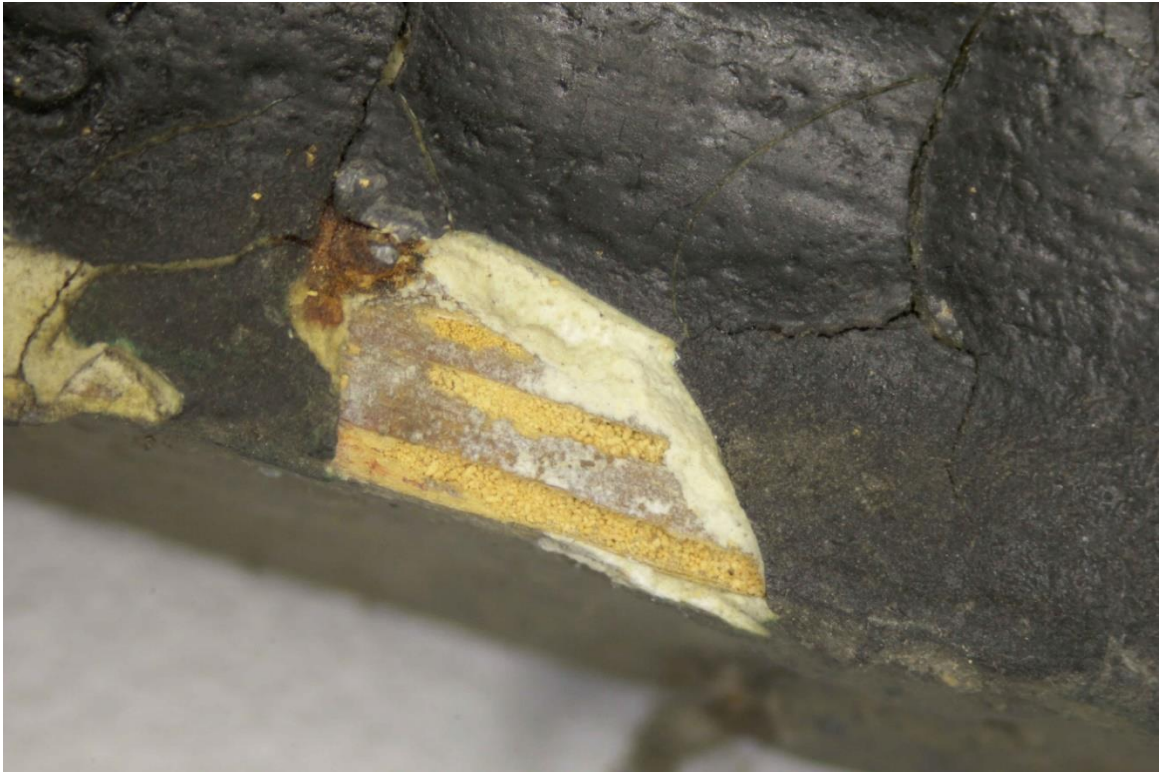
Obr. 11: Defekt v horní části díla. Tmel nanesený přímo na dřevěném napínacím rámu.
