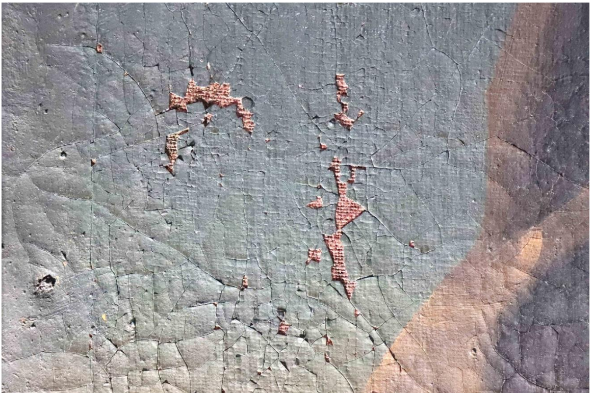
Obr. 190: Stav před restaurováním, detail poškození, krakeláž, ztráta barevné vrstvy včetně podkladu.
