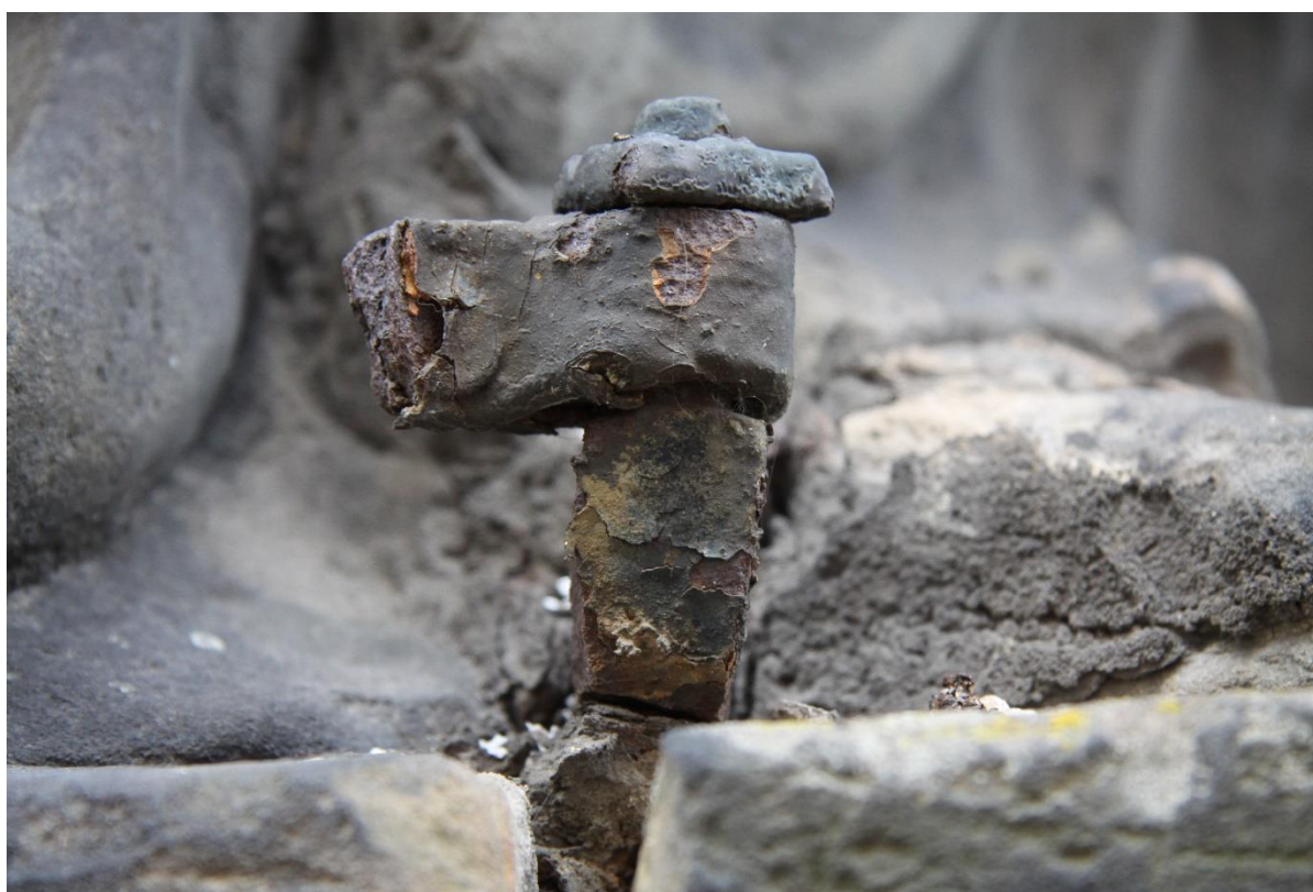
obr. 33. Korodovaný pozůstatek kovové lucerny před vyjmutím
