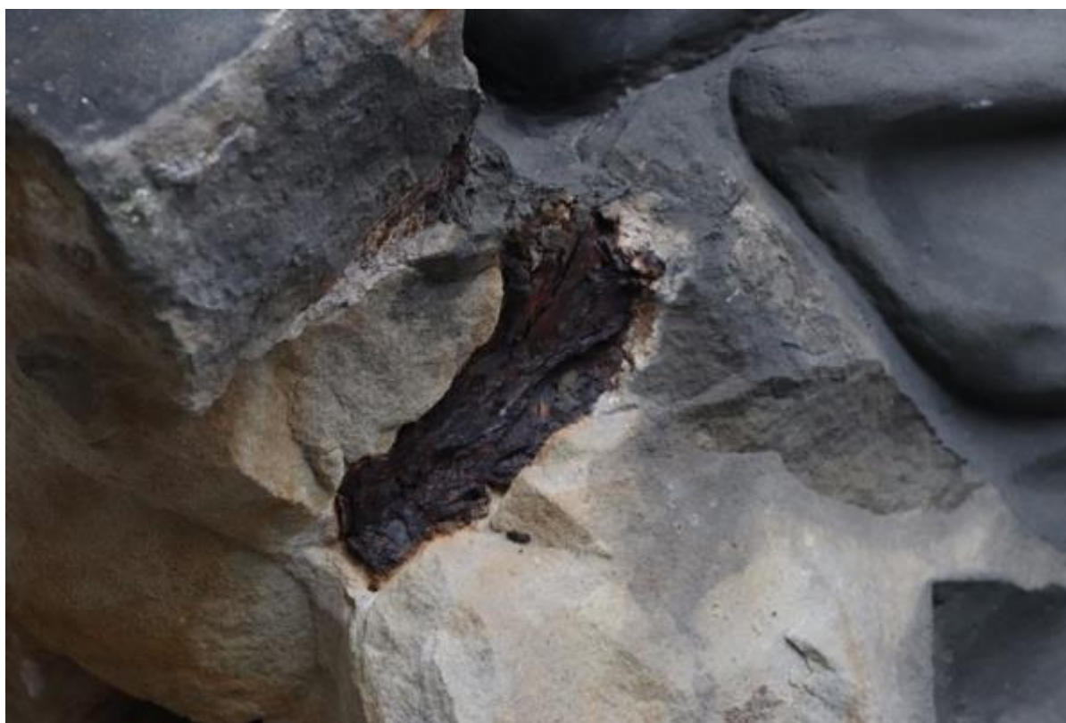
obr. 30. Korodovaný pozůstatek kovové lucerny, který v minulosti způsobil rozlomení kamene
