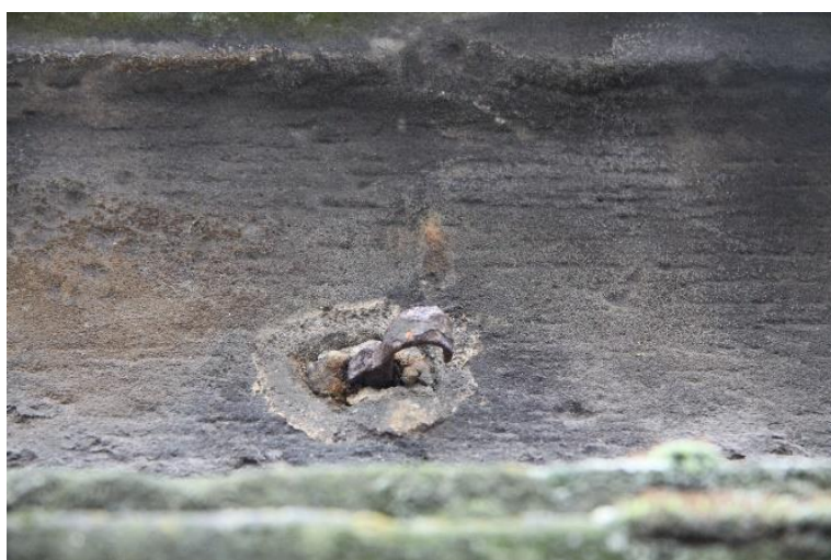
obr. 17. Distribuce korozních produktů
