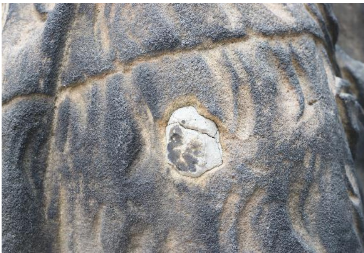
obr. 29. Degradovaný cementový tmel
