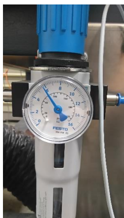
Obr. 3.7 – Jednotka úpravy stlačeného vzduchu
