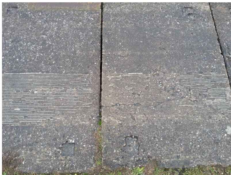
Obrázek 11 Poničená vodící linie na nástupišti v Žandově
