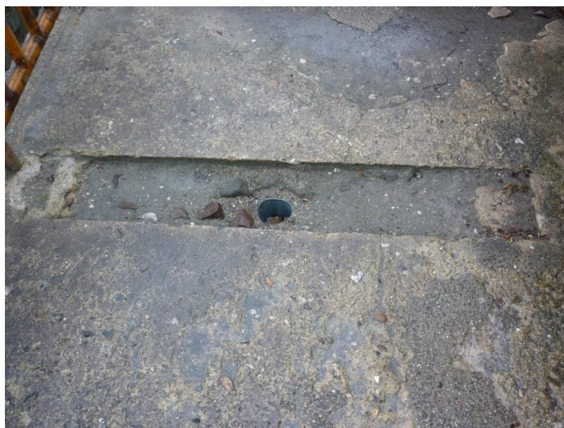
Obrázek 7 Nebezpečné nerovnosti v přístupové cestě na zastávku Malá Veleň
