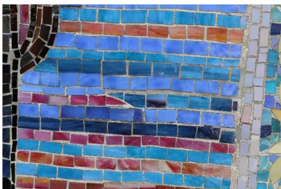
Detail poškození mozaiky v oblasti pozadí figury, kde došlo ke ztrátě adheze mozaikových dílků k maltovému loži. Stav před restaurováním.
