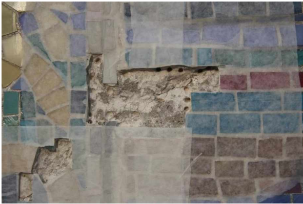
Obr. 18: Detail mozaiky na průčelí kostela v Táboře-Klokotech. Defekt připravený pro znovuosazení skleněných dílků – stav po zajištění okolí přelepem, jeho konsolidaci a redukci původní osazovací malty.
