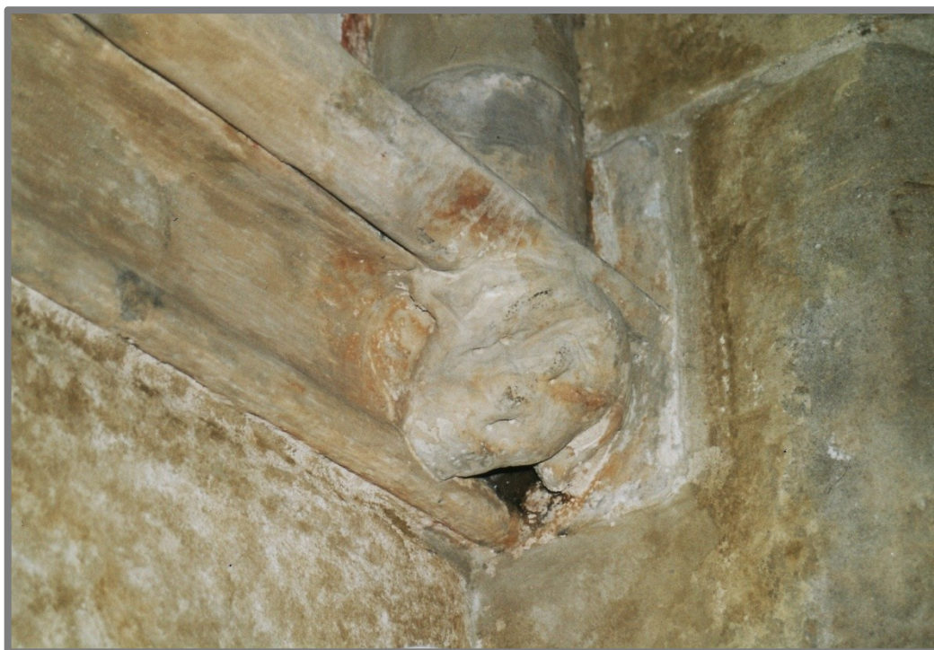
Obr. 45: Jedna ze dvou záměrně destruovaných hlaviček pod parapetní římsou presbytáře (foto: E. Vymětalová).
