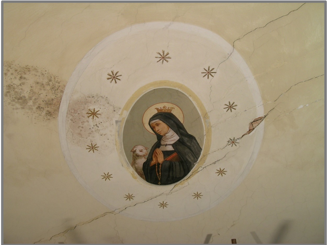
Obr. 66: Medailon se sv. Anežkou. Stav před restaurováním. Malba je narušena hlubokými prasklinami, v levé části patrna partie napadená plísněmi (foto: E. Vymětalová).
