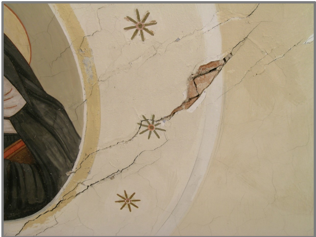
Obr. 67: Pravá část medailonu s ozdobným rámem, narušená prasklinami. Stav před restaurováním (foto: E. Vymětalová).
