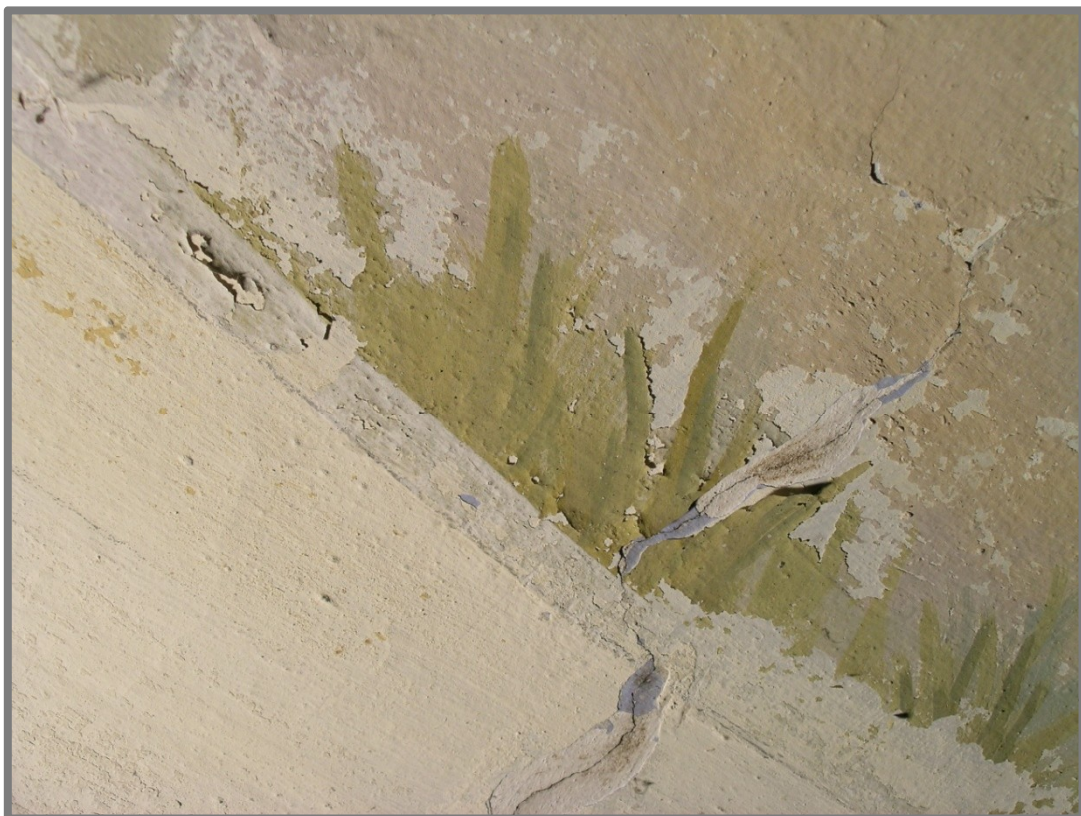
Obr. 20: Detail dolního okraje malby na rozhraní ozdobného rámu. Patno kritické uvolnění barevné vrstvy v šupinách (foto: E. Vymětalová).
