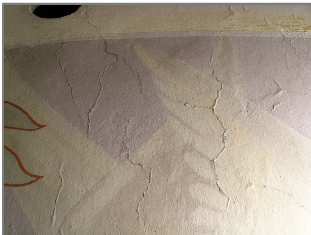
Obr. 23: Horní partie malby s motivem andělských křídel. Barevná vrstva je narušena krakeláží (foto: E. Vymětalová).
