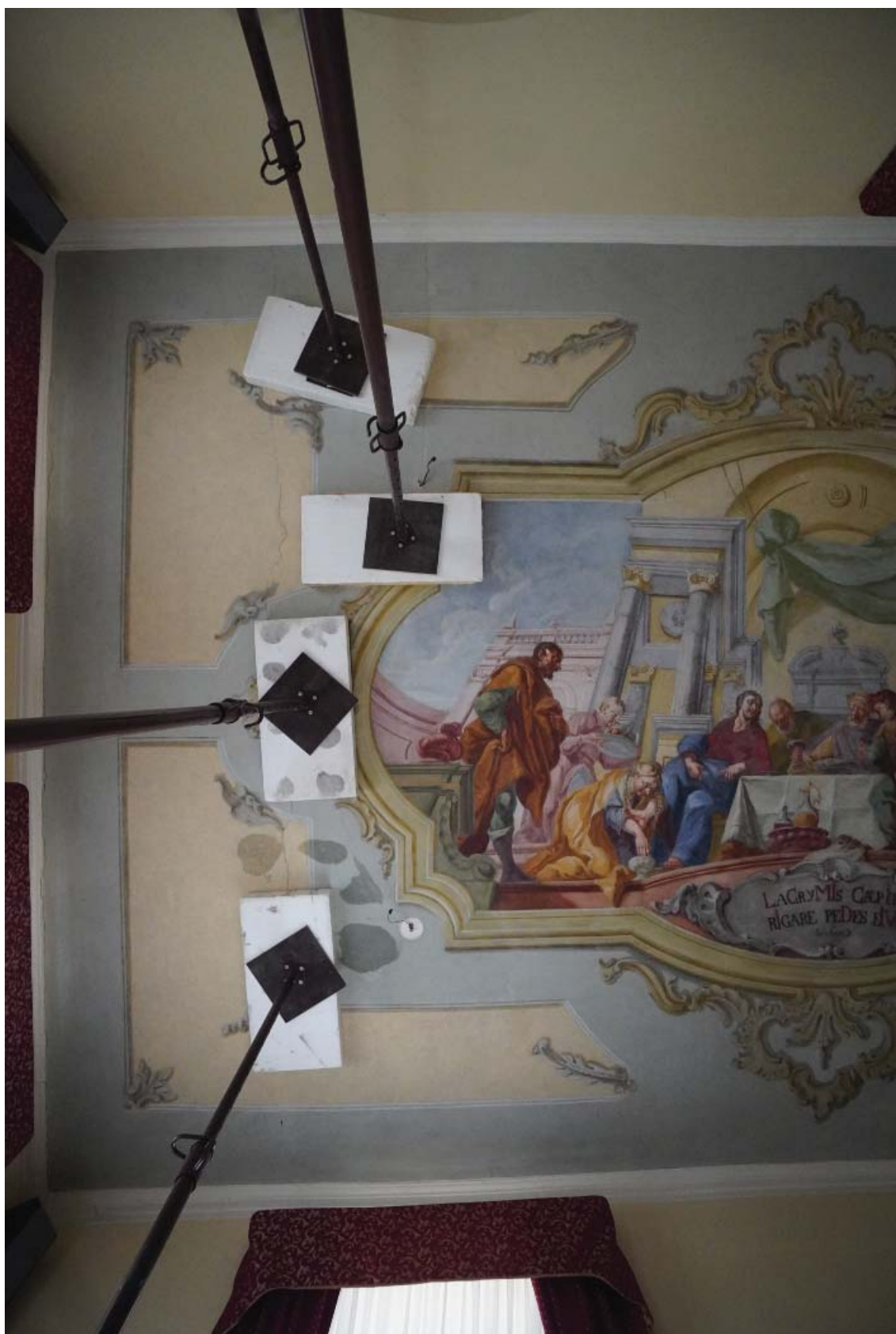
Obr. 47: Levá část nástropní malby v sále. Dekorativní rámování včetně šedých a okrových ploch je druhotně přemalované a rekonstruované (patrně bylo v minulosti překryté celoplošným nátěrem).
