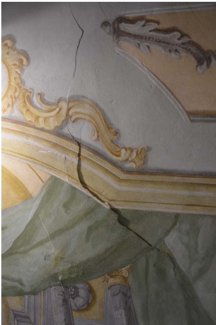
Obr. 54: Starší opravy trhlin, tmely a retuše. Patrný velký odskok oddělené omítky s malbou.
