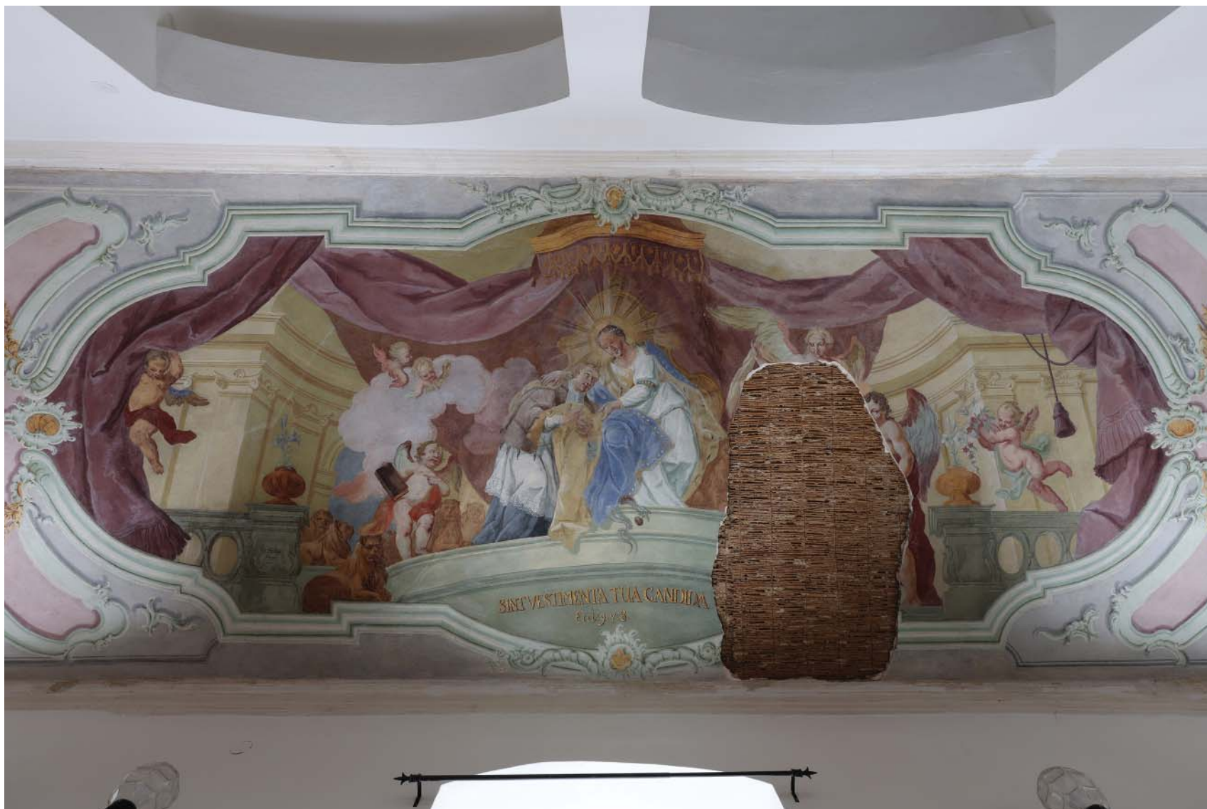
Obr. 05: Hlavní scéna po odpadnutí části malby, leden 2023.
