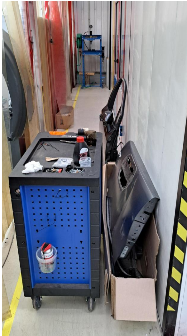
Obrázek 8: Blokace přístupu k uzávěru plynu
