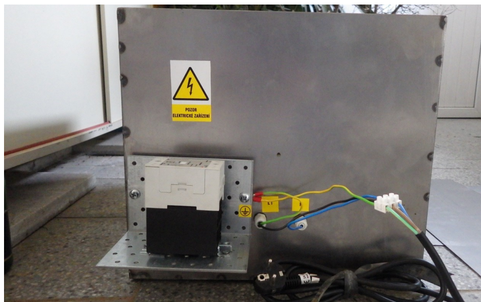
Obr. 11 – Elektroinstalace 2, provizorní zapojení
