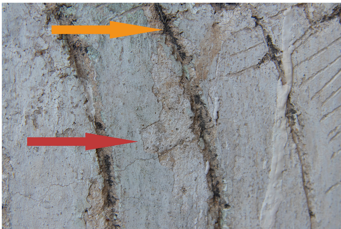
Obr. 27: Detail zelené skvrny (reziduí mědi) na omítkových vrstvách v oblasti kotvy hromosvodu.
