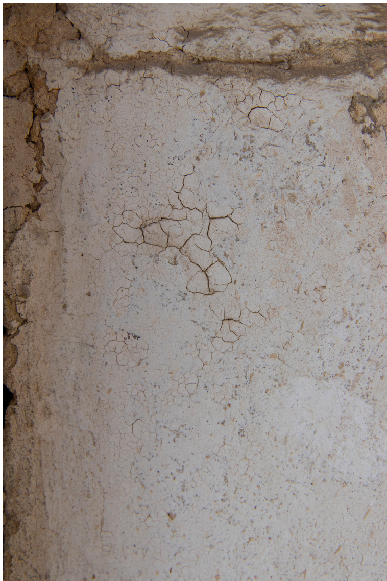
Obr. 25: Detail kraláče na druhotném silném plněném vápenném nátěru v oblasti sloupu na levé části úseku.
