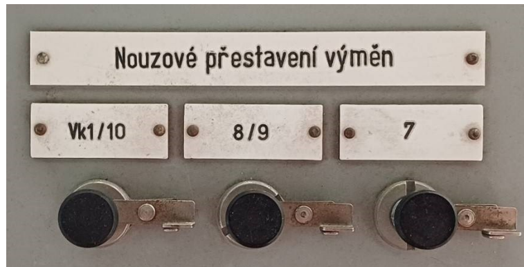
Obr. 15 - příklad tlačítka nouzového stavění výměn, dopravní sál DFJP
