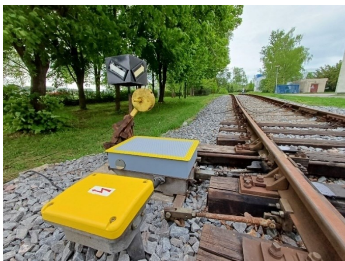
Obr. 24 - přestavník s výhybkou a kabelovým závěrem, VVCD Doubravice, stav k 24.4.2025
