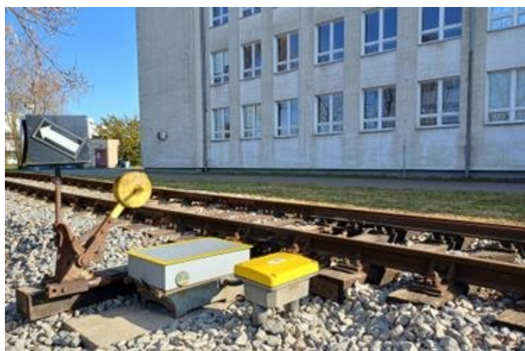
Obr. 3 - přestavník EP 600 s výhybkou, VVCD Doubravice
