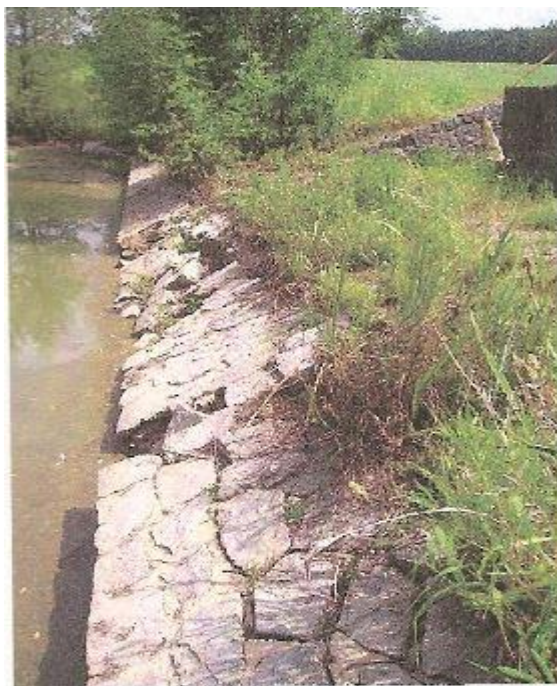
Obrázek 23: Stav hráze před opravou
