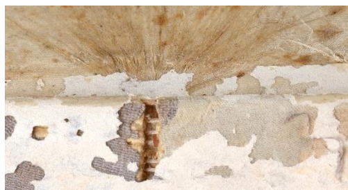
Obrázek 73 Zapuštěný vaz viditelný pod poškozením (Nadační fond Jendy Rajmana)
