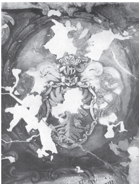
Obr. 2: Pražský hrad, velká síň Zem. desek: Erb z r. 1666 na klenbě, po upevnění barev. vrstvy a po vytmelení odpadlých částí r. 1953. Foto: Slánský, B., Příspěvek k řešení otázky retuše a rekonstrukce nástěnných maleb. Umění 2, č.4, Praha 1954,
