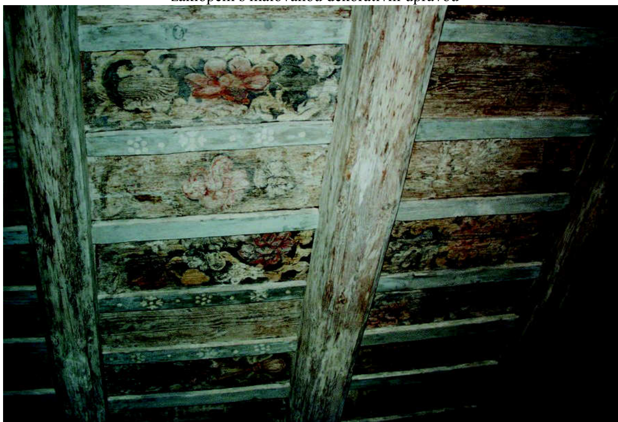
Obr. IV/2: dům čp. 36 - druhý pohledový dřevěný trámový strop se záklopy a lištami a malovanou dekorativní úpravou, stylizovaným rostlinným dekorem
