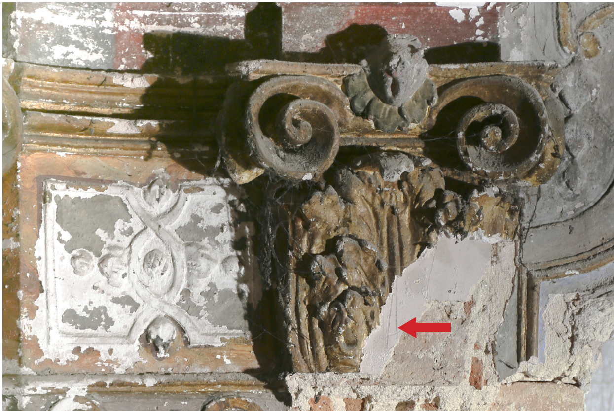
Obr. 44: Rytá svislá linie značící osu hlavice. Ostré boční nasvícení. Oblast poškození na západní (oltářní) stěně.
