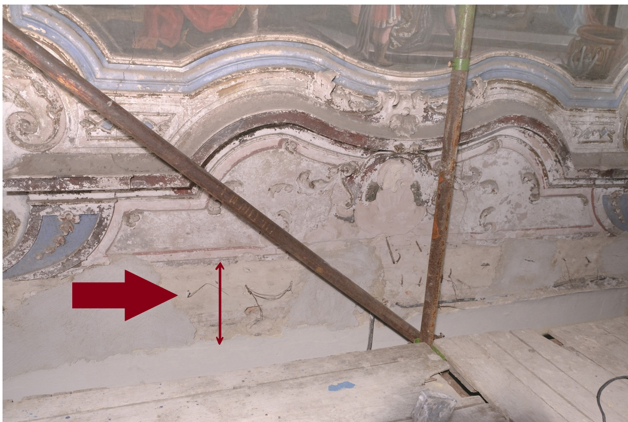
Obr. 55: Místo rozhraní nepůvodního odstraněného stropu označené červenou šipkou. Ve spodní části snímku je patrné, že štuk byl odstraněn a jsou k vidění zbytky armatur sloužících k přikotvení štukových prvků. Dále jsou místy viditelné i další maltové vysprávky.
