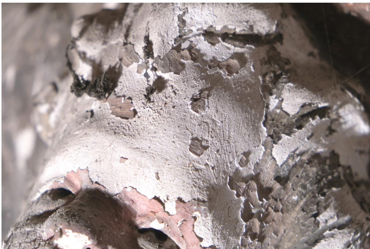
Obr. 21: Snímek detailu hlavy anděla dokumentující stav a charakter původního povrchu štukové výzdoby. Patrná je původní úprava povrchu štuků pod polychromií. Je zřetelné, že úprava byla relativně hrubá. Umělci zjevně předpokládali, že bude následovat křída, která povrchovou strukturu zjemní.
