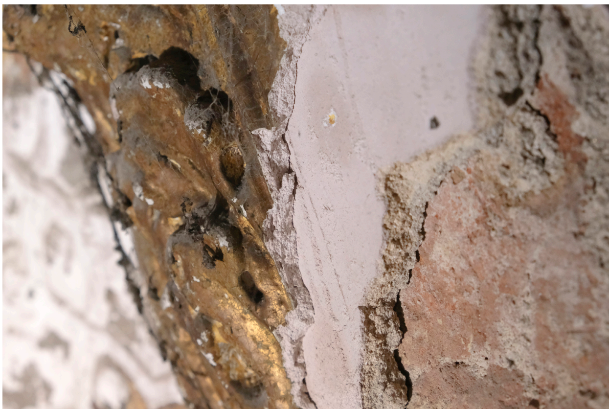
Obr. 10: Detail poškození centrální holubice klenební výzdoby. Zřetelná stratigrafie omítkových vrstev. Západní - oltářní stěna.
