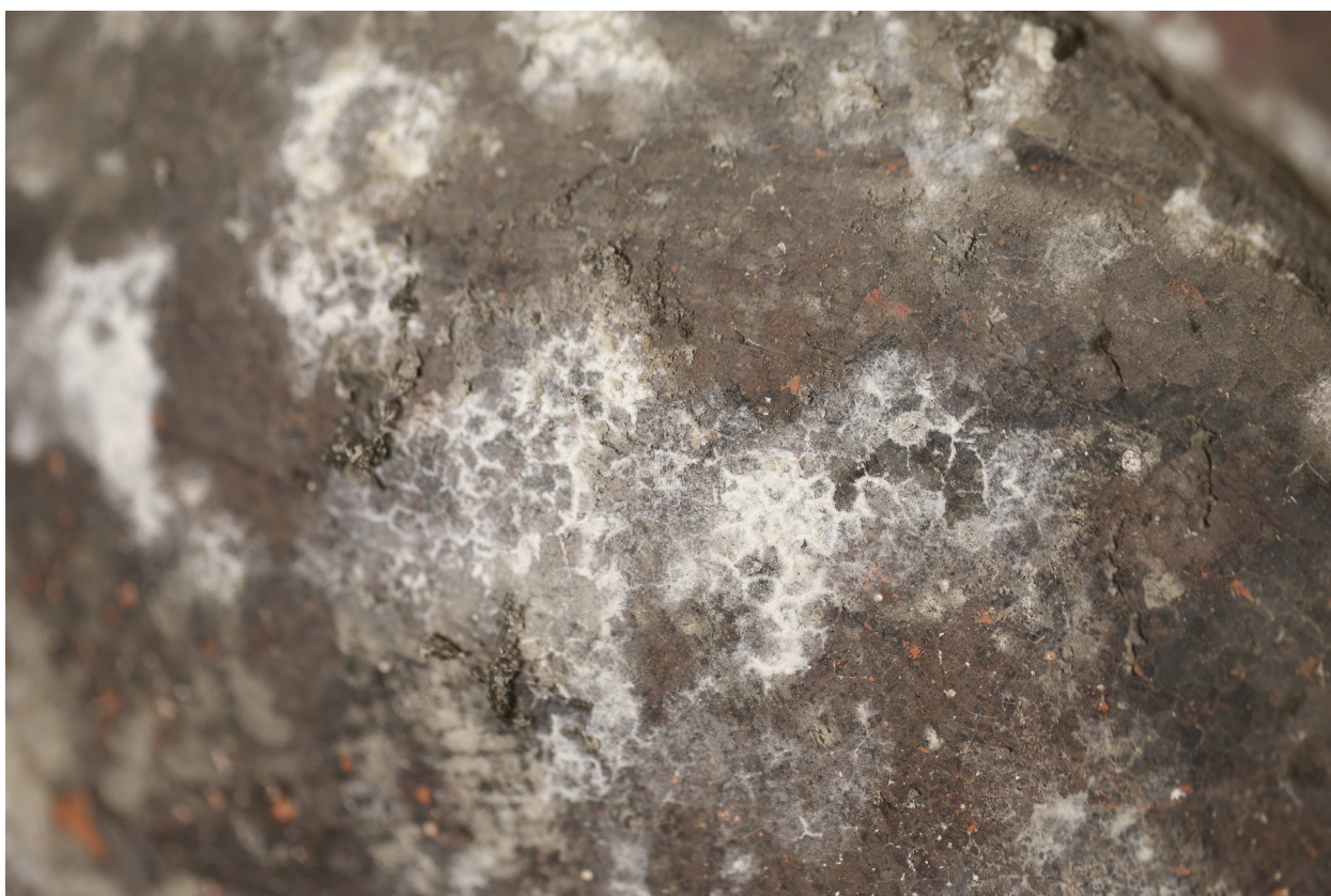
Obr. 82: Snímek dokumentující degradovaný (zčernalý) povrch plátkového stříbra. Na snímku je vidět, že povrch štuky je značně poškozen produkty biokoroze vláknitými houbami (plíseň).
