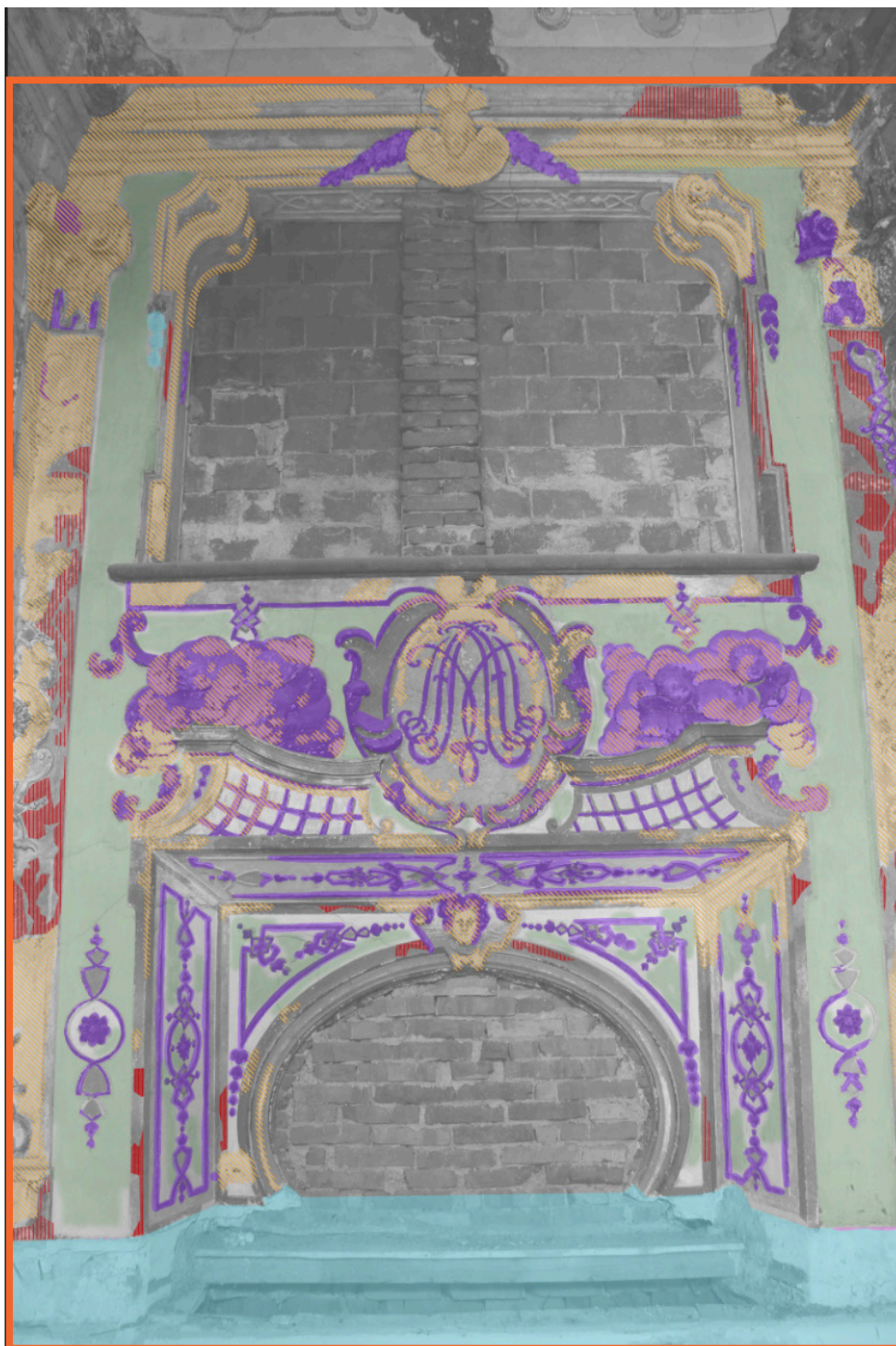
Grafický zákes: poškození
