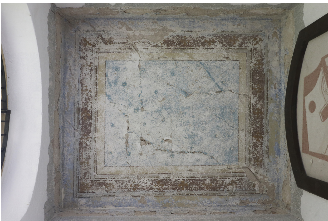
Obr. 03: Pohled na strop a horní část severní stěny v kapli č. VI. Na snímku lze pozorovat realizovanou sondu v severovýchodním koutu kaple.
