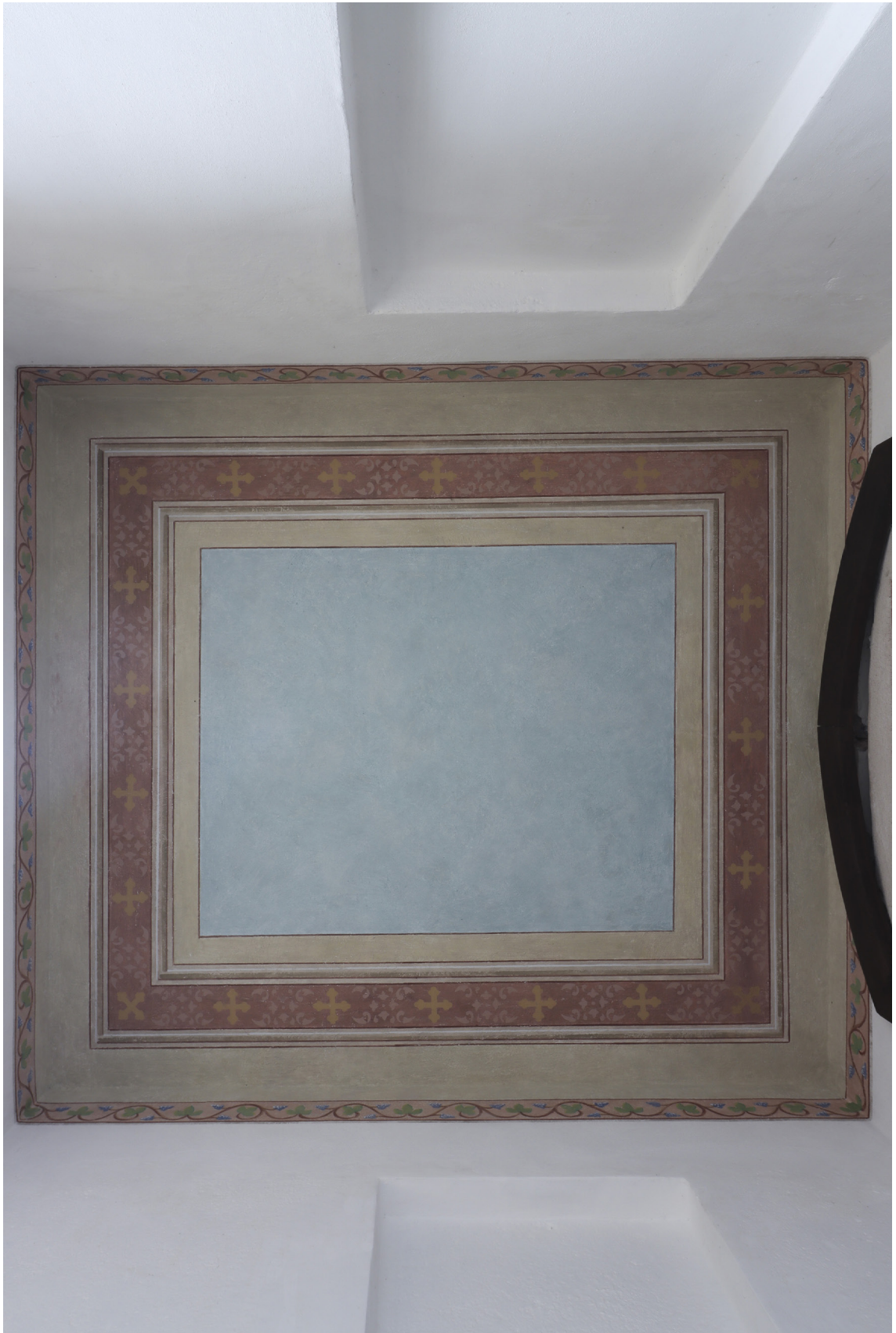
Obr. 26: Celkový pohled na nástropní malbu v kapli č. VII. Stav po restaurování.
