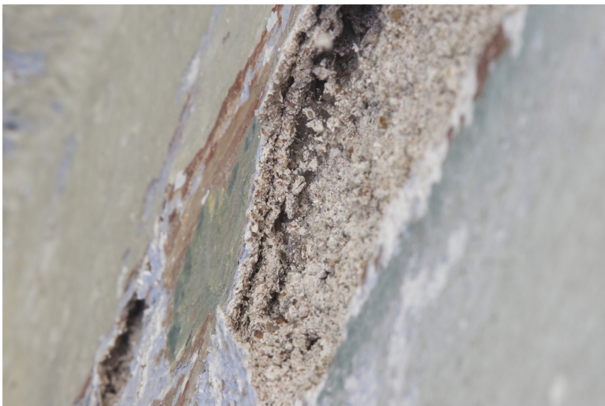
Obr. 84: Snímek dokumentující stav omítkové a barevné vrstvy po odkryvu. Na snímku lze pozorovat ohrožené nesoudržné části omítky.
