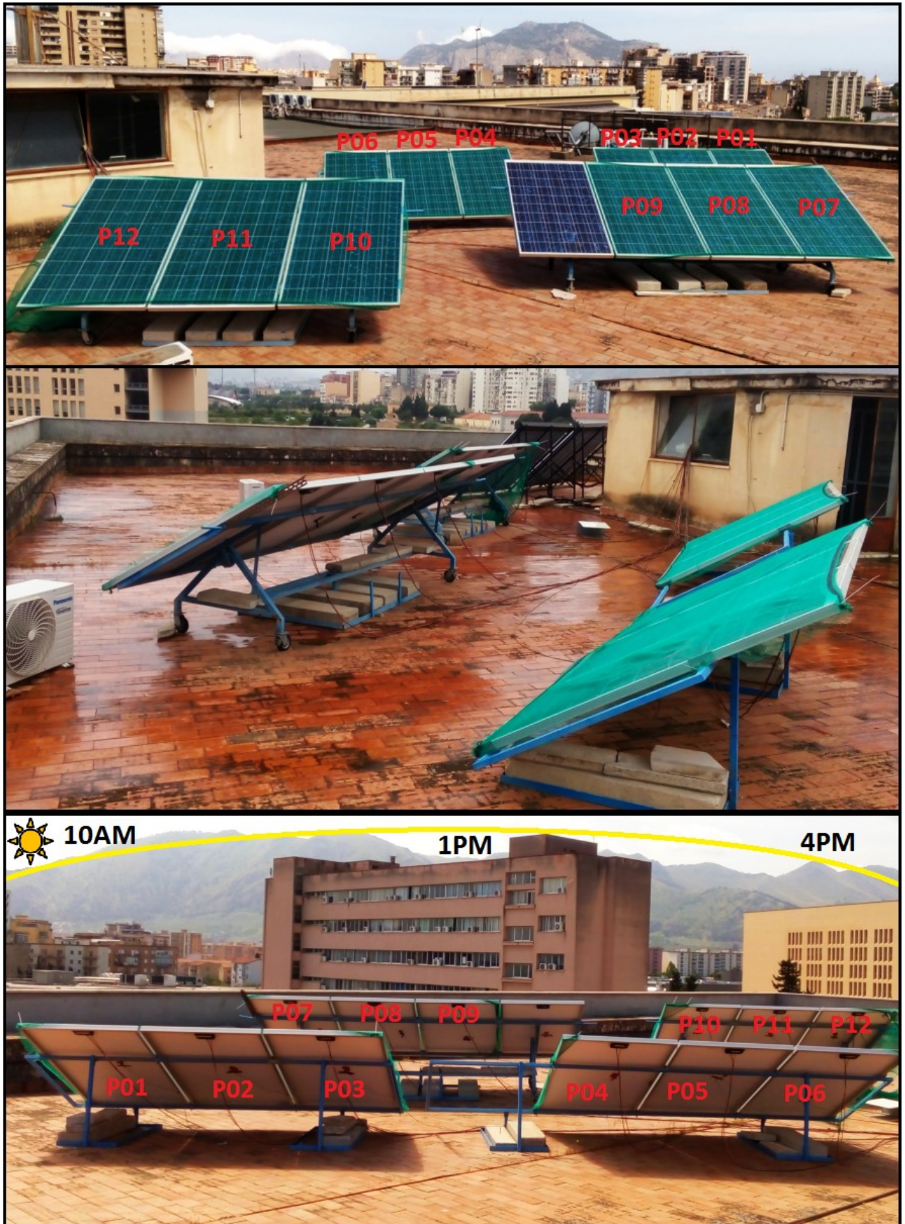
Obrázek 64 - PV pole umístěné na střeše budovy DEIM, univerzita PALERMO, ITALIE
