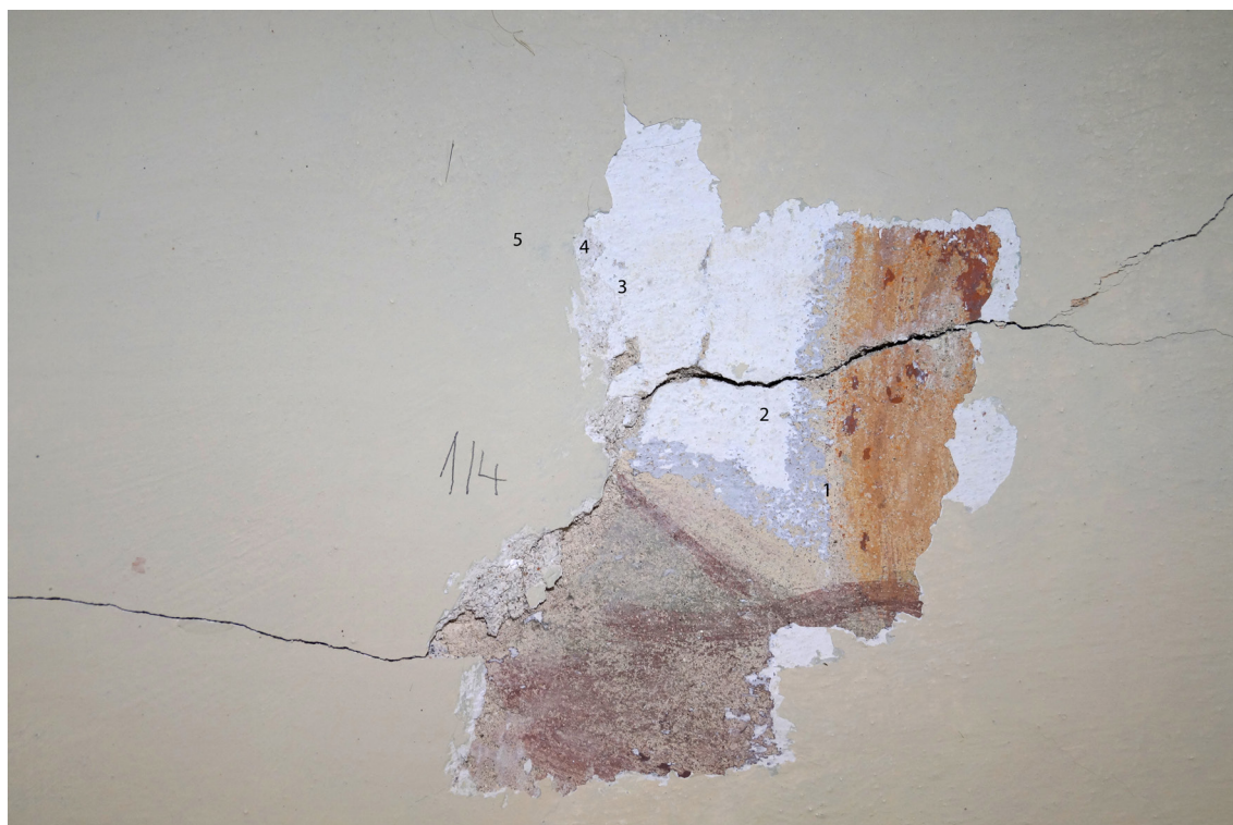
Obr 17 Sonda č. 1/4 a zkouška odkryvu na výmalbě zrcadla. 1. barokní malba (kaput mortuum, oranžová, modrá) 2. bílá; 3. bílá, 4. zelená, 5. okrová. Přes sondu probíhá vytmelená statická trhlinka.
