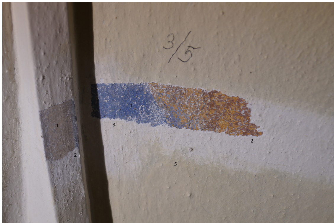
Obr 37 Sonda č. 3/5 - výmalba zrcadla a rám. 1. barokní malba (modrá, přelévá se do části rámu. oranžová, hnědá) rám šedookrová 2. bílá v ploše; 3. bílá, 4. chybí pouze min. fragменты, 5. okrová hlínka.
