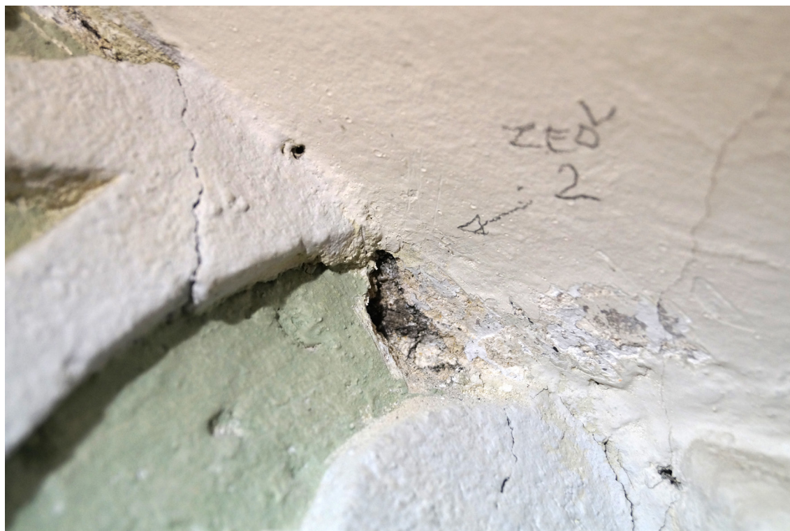
Obr 71 Sonda ZED 2 - za omítku příčky - šedá = silné nečistoty, povrch maleb se zdá poškozený
