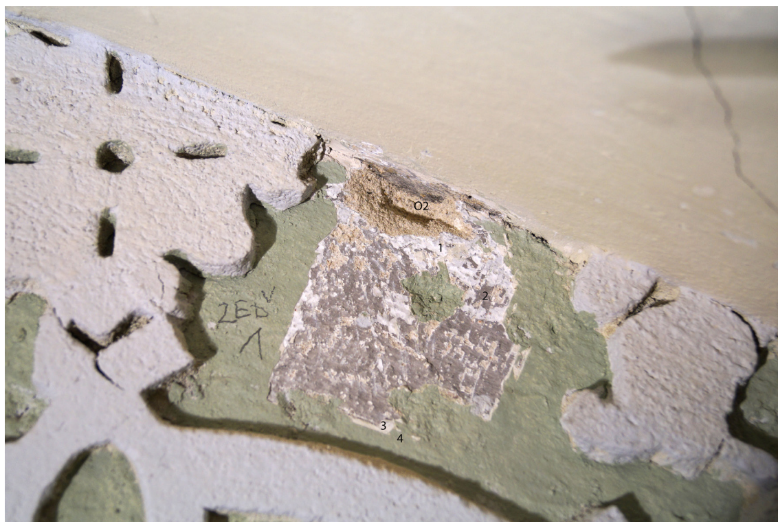
Obr 70 Sonda ZED 1 - na příčce mezi jídelnou a salómem O2 - klasicistní omítka vložené příčky 1. bílá (podkladová) 2. šedá 3. bílá 4. zelená v pozadí bílá na dekorech (v současnosti obnovena nalezená původní barevnost).
