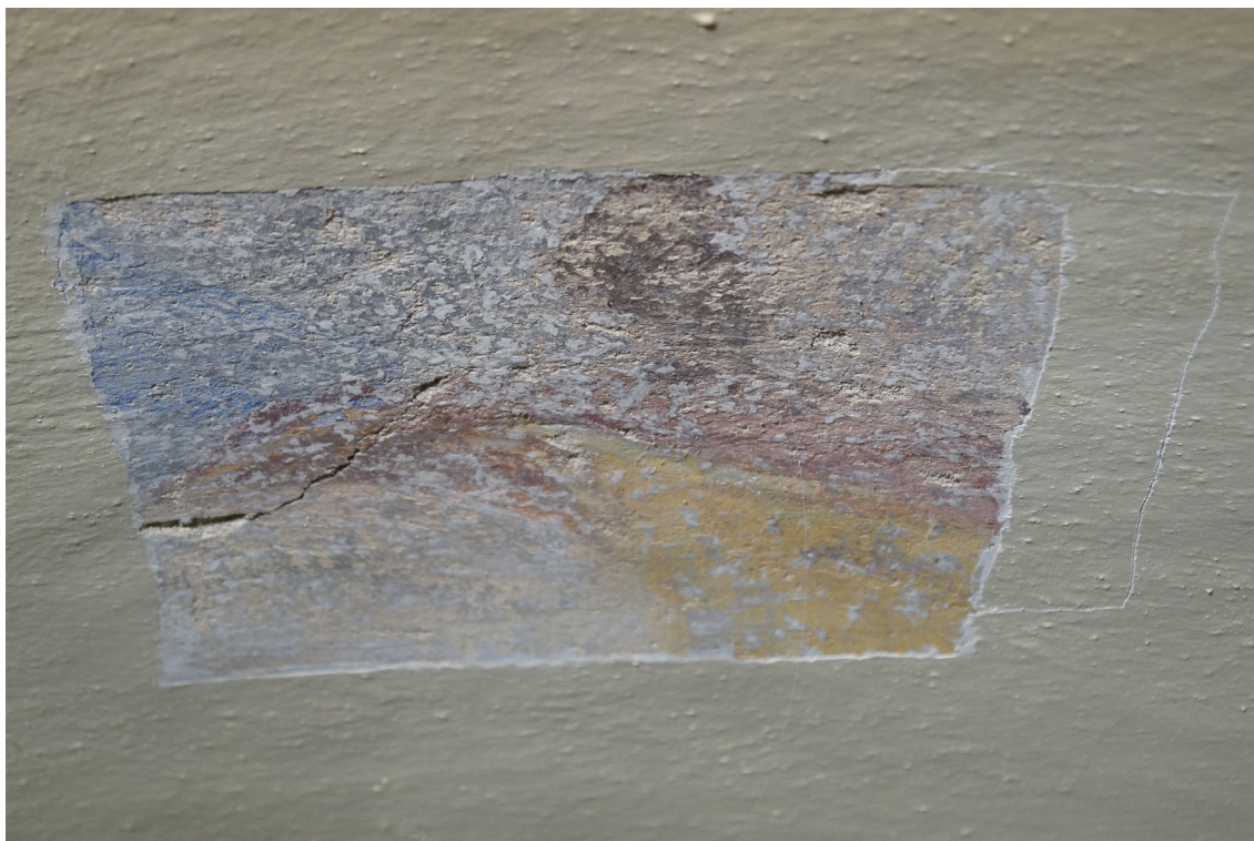
Obr 72 Sonda z předchozího průzkumu (Švéda, Besta) - odkryv kladívkem způsobuje záseky a desintegraci intonacové vrstvy. Překryvy je nutné odkrývat planžetovým skalpelem, i tak dochází k lokálním ztrátám u secco vrstev, přilnutých k následným nátěrům.
