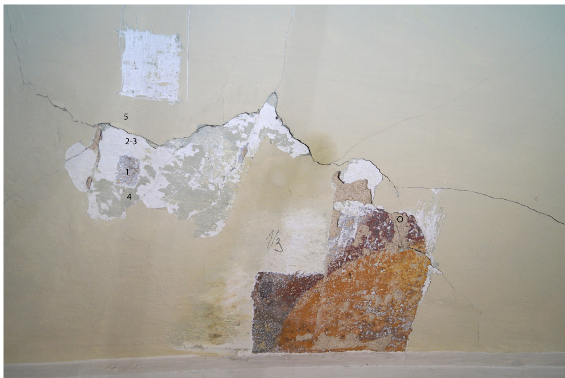
Obr 16 Sonda č. 1/3 a zkouška odkryvu - výmalba zrcadla. O -barokní omítka 1. barokní malba 2.bílá, 3. bílá, 4. zelená, 5. okrová. Nad sondou probíhá statická trhlinka, již vyspravená, v současnosti se propisuje ve formě tenké praskliny.
