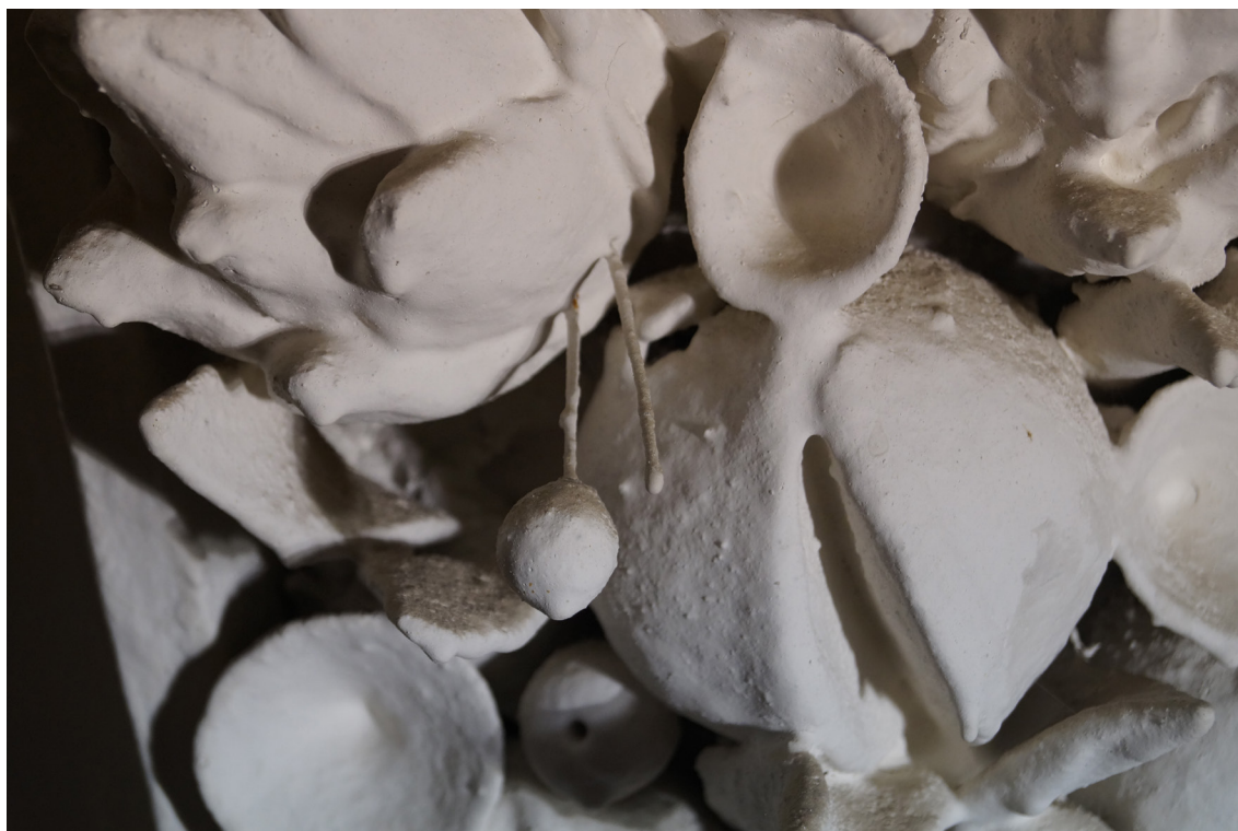
Obr 57 Poškození štuky - zalití modelací v detailu, odpadané části štuků (zejména z kovových konstrukcí), na spodních částech zřetelné stékance stříkaného nátěru.
