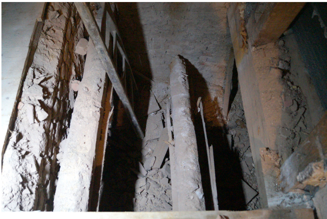
Obr 12 Odhalený prostor v podlaze nad klenbou (cca v místě rozhraní pole č. 1, žebra č. 6 a pole č. 5): uhnílé trámy, které zatěžují vrcholnice klenby. V těchto místech se na omítkách klenby nacházejí již v minulosti zatmelené statické trhliny.
