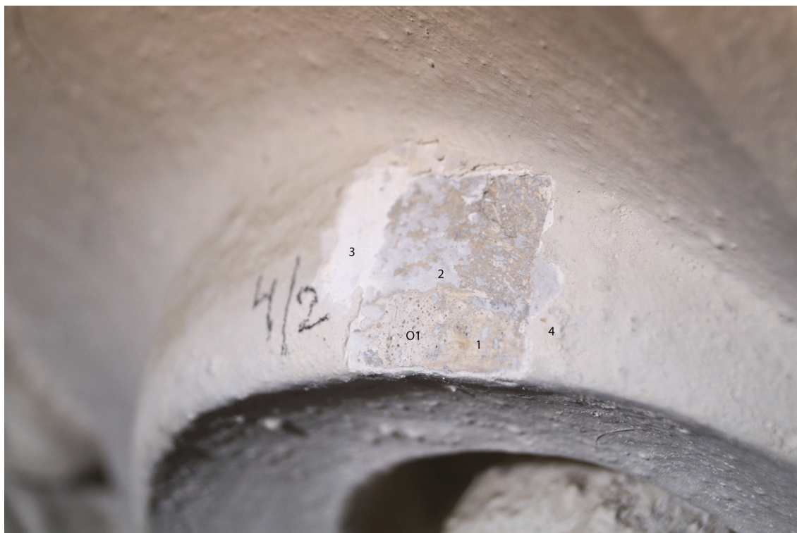
Obr 41 Sonda č. 4/2 - výběh voluty na rámu zrcadla O1 velmi světlý štuk s obsahem kamenné drtě (černé tečky) 1. „režný“ okrovošedý hladký povrch štuk, 2. tenký světlešedý nátěr 3. bílá vápenná 4. poslední silná plněná bílá
