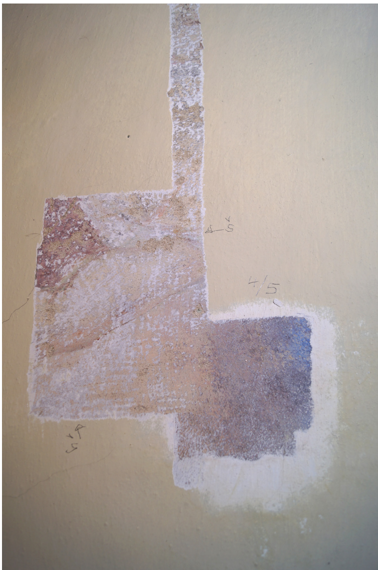
Obr 44 Zkouška odkryvu - sonda č. 4/5 - vpravo proveden planžetovým skalpelem. Vlevo odkryv z předchozího průzkumu (Švéda, Besta - označeno Š) odkryv proveden pravděp. kladívkem - ztráta intonacové a barevné vrstvy.
