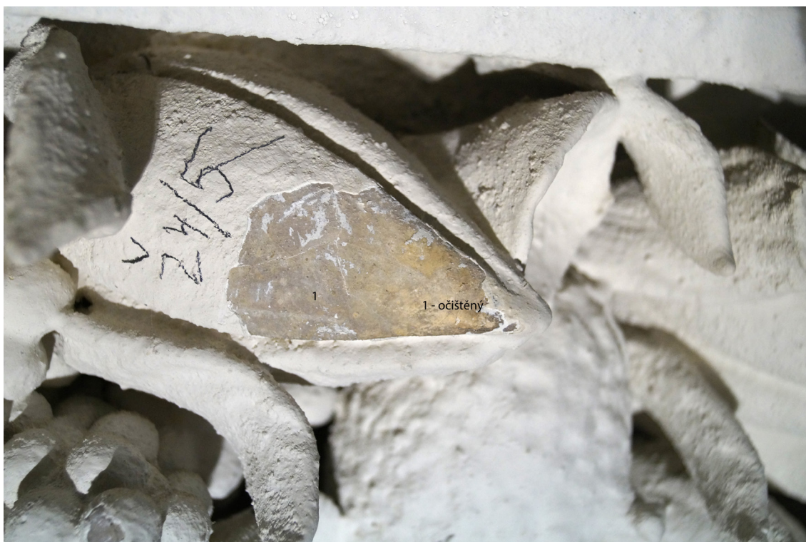
Obr 52 Sonda č. Ž4/5 na ovocných trsech - č. 1. šedookrový hladký povrch štku se 2-3 bílými nátěry. V této sondě jde šedý povlak očistit teplou vodou (spíše nečistoty - odkrývá se na původní krémový povrch, shodný, jako ž4/2 – velká sonda
