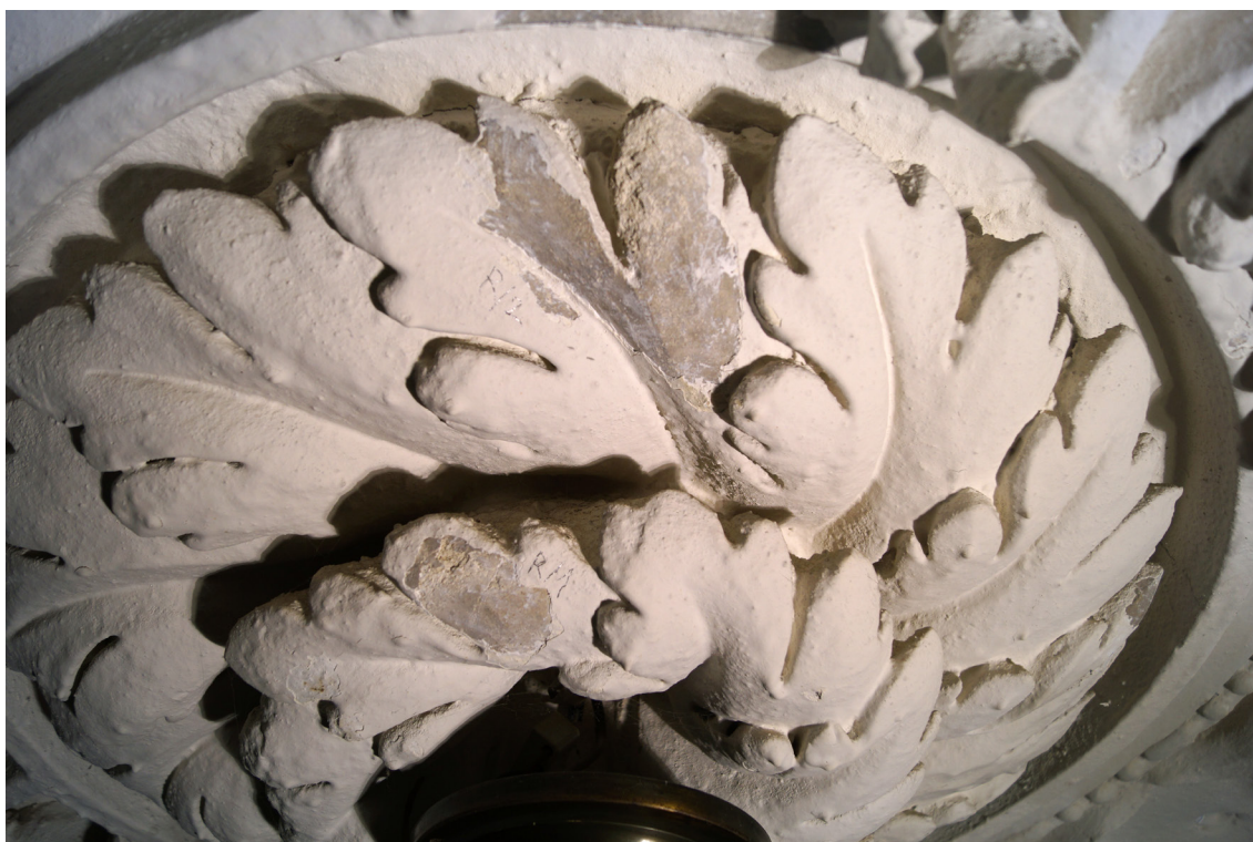
Obr 54 Sonda č. R/2 na středové rozetě - č. 1. šedookrový hladký povrch štuk s bílými nátěry.
