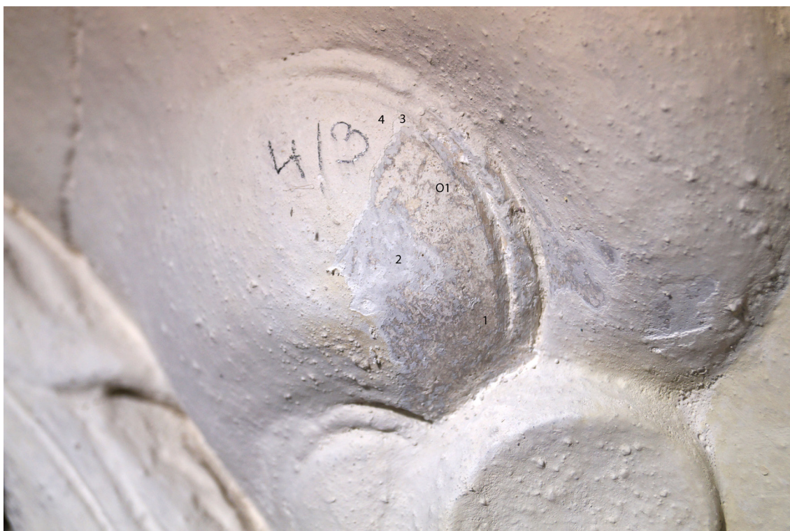
Obr 42 Sonda č. 4/3 - „mraky“ O1 velmi světlý jemnozrný štuk 1. „režný“ okrovošedý a hladký povrch štuk, 2. tenký světlešedý nátěr 3. bílá vápenná 4. poslední silná plněná bílá
