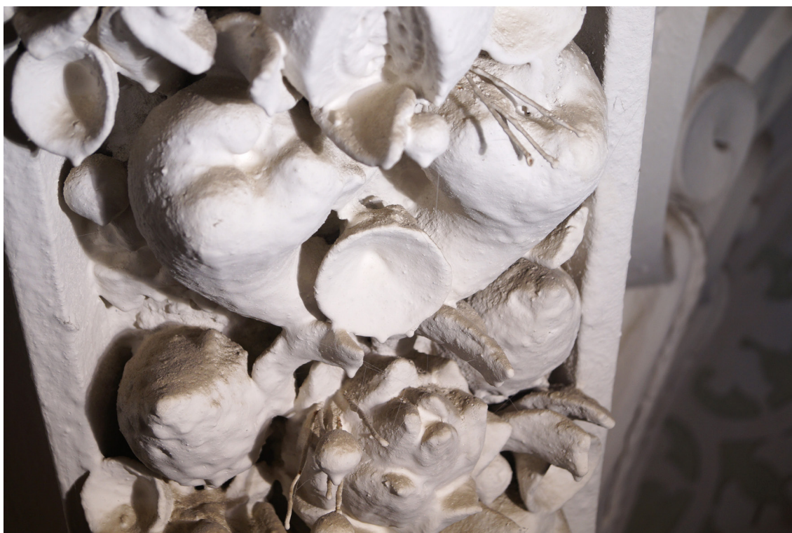
Obr 56 Poškození štuky - zalití modelací, odpadané části štuků (zejména z kovových konstrukcí), na spodních částech zřetelné stékance stříkaného nátěru.
