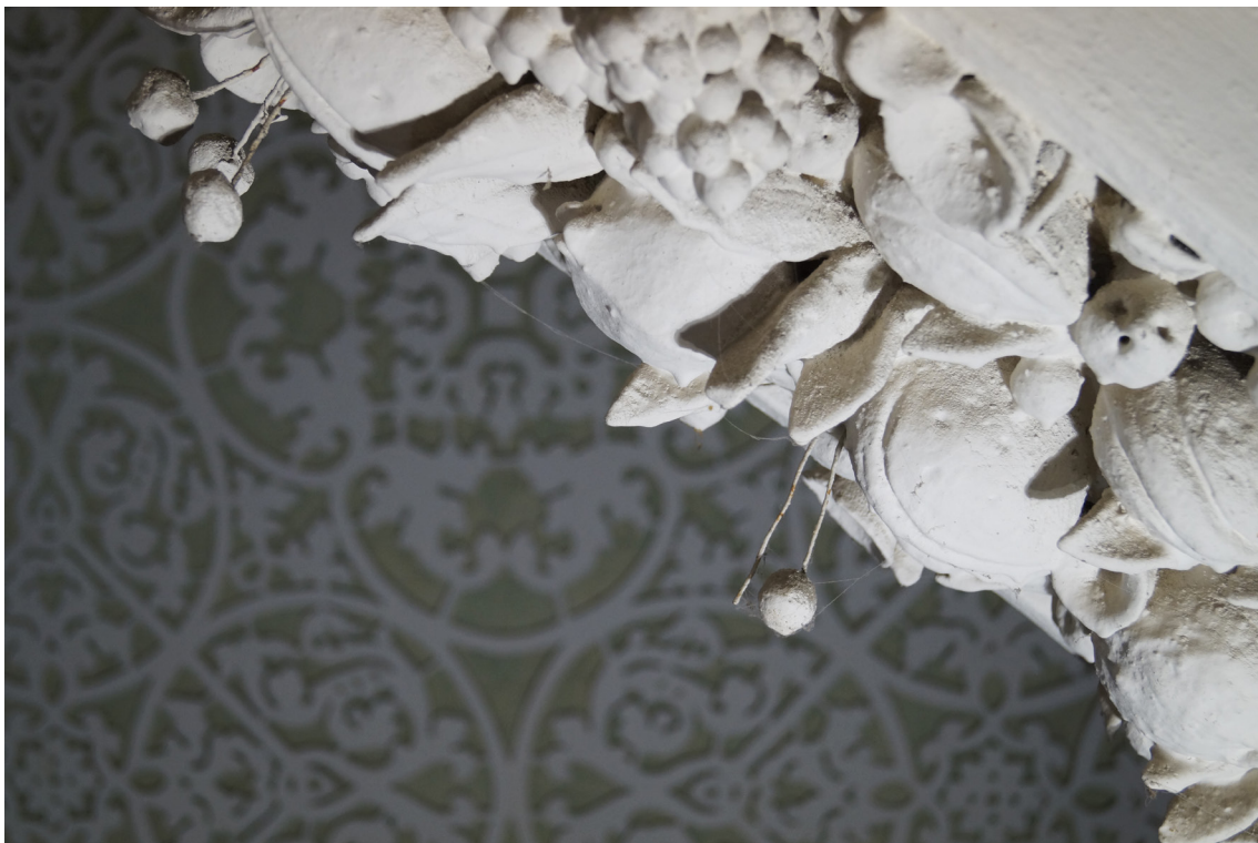
Obr 59 Poškození štuky- zalití modelací v detailu, odpadané části štuků (zejména z kovových konstrukcí), na spodních částech zřetelné stékance stříkaného nátěru.
