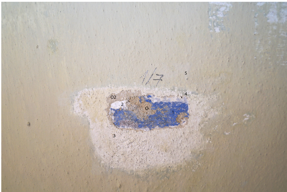
Obr 20 Sonda č. 1/7 - výmalba zrcadla. O - tmavší okrovorůžová barokní omítka 1. barokní malba (modrá) 2. bílá; O2 - šedý tenký štuk (vysprávka) 3. bílá (podkladová) 4. fragmenty zelené, 5. okrová hlínka.
