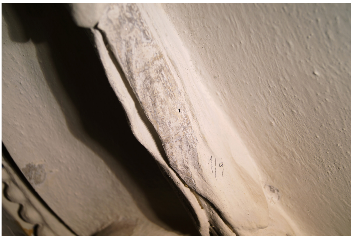
Obr 23 Sonda č. 1/9 - listovec na rámu zrcadla 1. „režný“ šedookrový povrch štku na něm 3 vrstvy bílé, poslední silná a hrubá (plněná).
