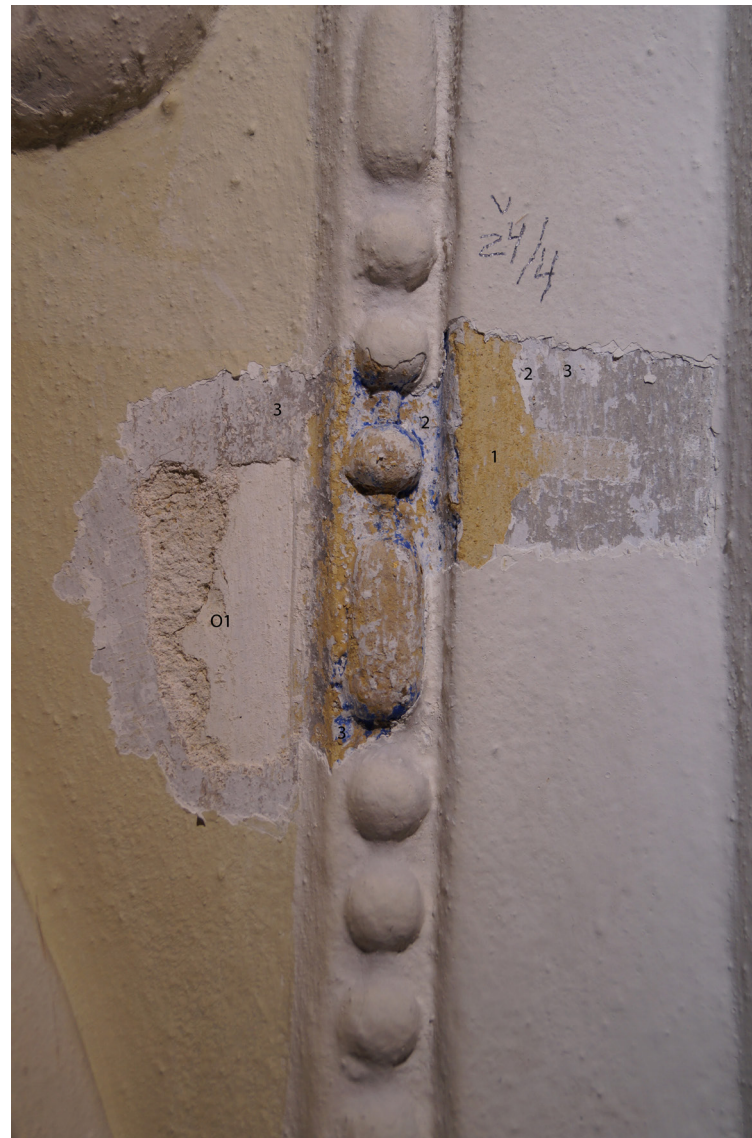
Obr 51 Sonda Ž4/4 - 1. okrová podklad pod zlacení, ostatní plochy smetanový hladký povrch 2. bílá - podklad (přes všechny vrstvy) 3. modrá v pozadí perlovce, zlaté akcenty na vrcholech perlovce a spojovacích nitkách, šedá ostatní plochy (vlevo vysprávka?)
