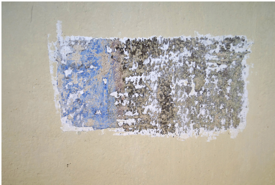
Obr 73 Sonda z předchozího průzkumu (Švéda, Besta) - problematické dočišťování přilnutého následného vápenného nátěru.
