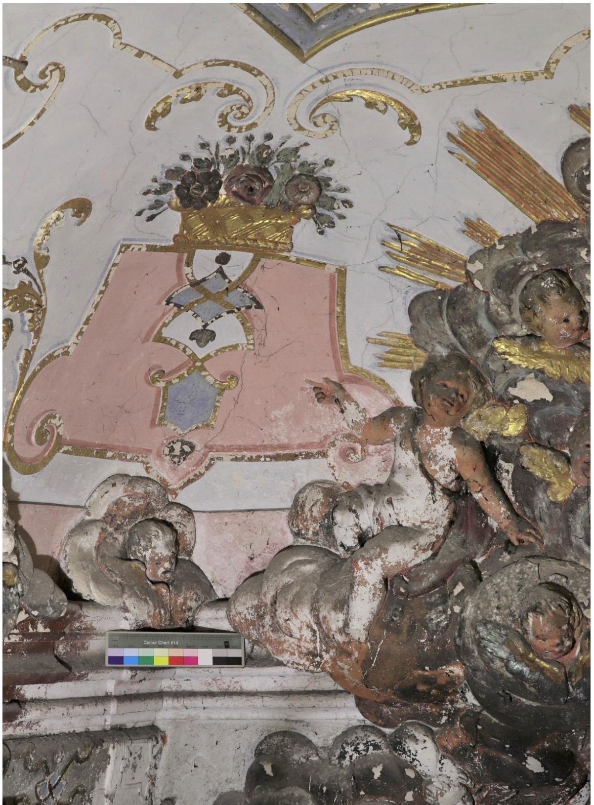
Obr. 7 Stav před restaurováním.
