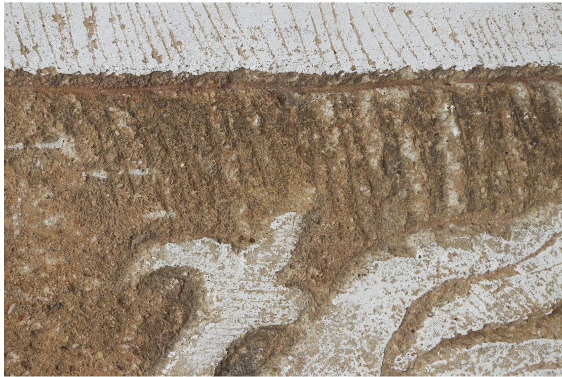
Obr. 22: Poškození v podobě ztmavlého povrchu omítky v důsledku sulfatizace povrchu a cákance neznámého původu. Stav před restaurováním.
