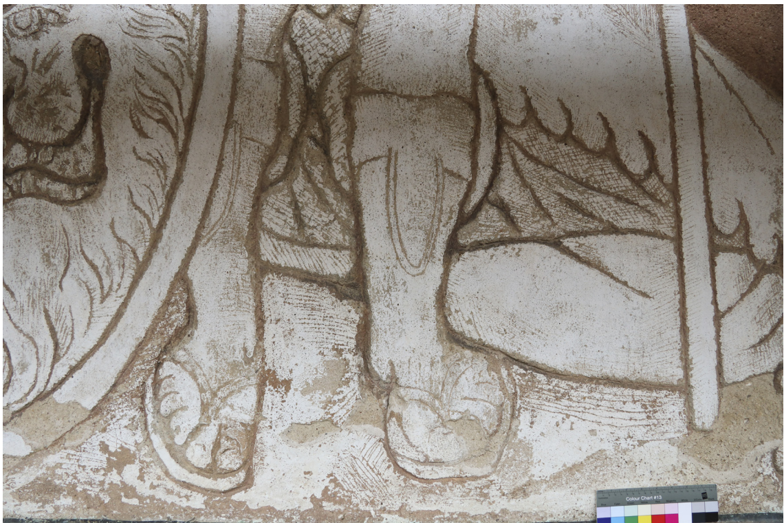
Obr. 15: Spodní část restaurovaného úseku s výjevem Hrdinu v antikizující zbroji s nejrozsáhlejší degradací omítkových vrstev . Stav před restaurováním.
