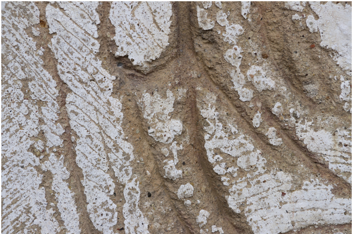
Obr. 20: Detail zachycující erodovaný povrch omítky a zaslepenou jemnou šrafuru druhotným vápenným nátěrem. Stav před restaurováním.
