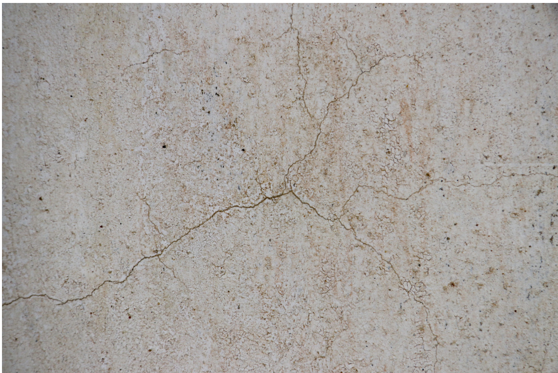
Obr. 26: Detail dokumentující vlasové trhliny a nečistoty na druhotném vápenném nátěru.
