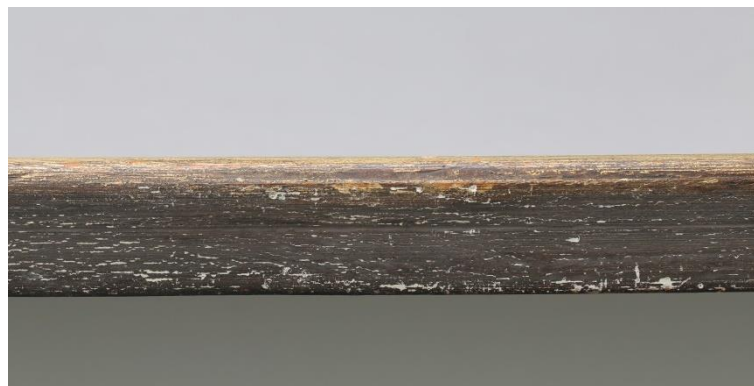
Obrázek 35 Detail poškození povrchové úpravy rámu.
