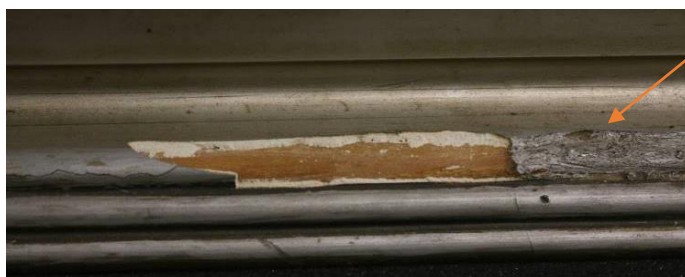
Obrázek 14 Poškození povrchové úpravy rámu a retuš práškovým kovem přes defekt.
