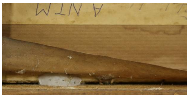
Obrázek 103 Detail nefunkční netěsné adjustace a biologického napadení.
