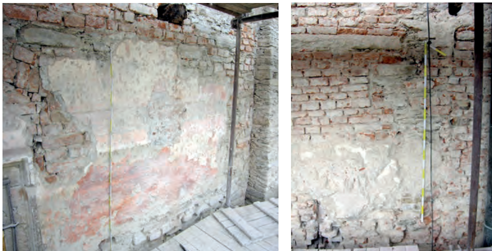
Obr. 1, 2 Žleby, zámek, východní průčelí, některé nálezkové situace při obnově, jež zůstaly prakticky neryhodnoceny a nedokumentovány najatou restaurátorkou. (Foto V. Jesenský, 2012)
