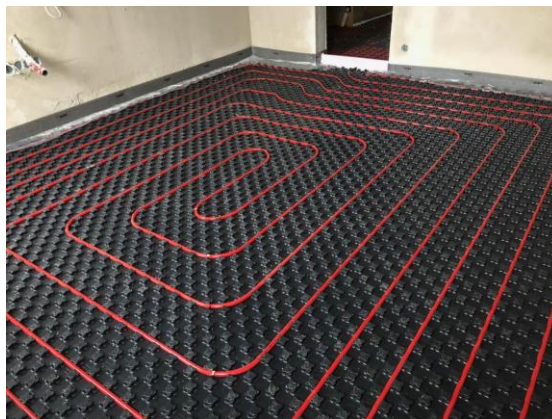
Obrázek 10: Trubky podlahového topení (VKN s.r.o., 2025)
