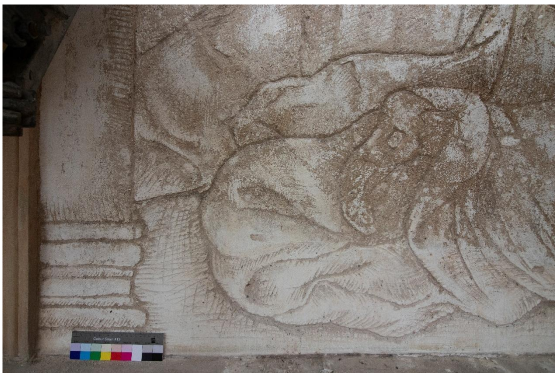
Obr. 26 - Spodní partie (draperie a sloup), levý úsek, výjev B5, stav po tmelení, denní světlo.
