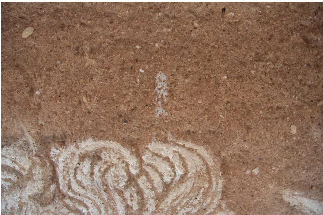
Obr. 7 - Ukázka poškození – cákanec, stav před restaurováním, denní světlo.
