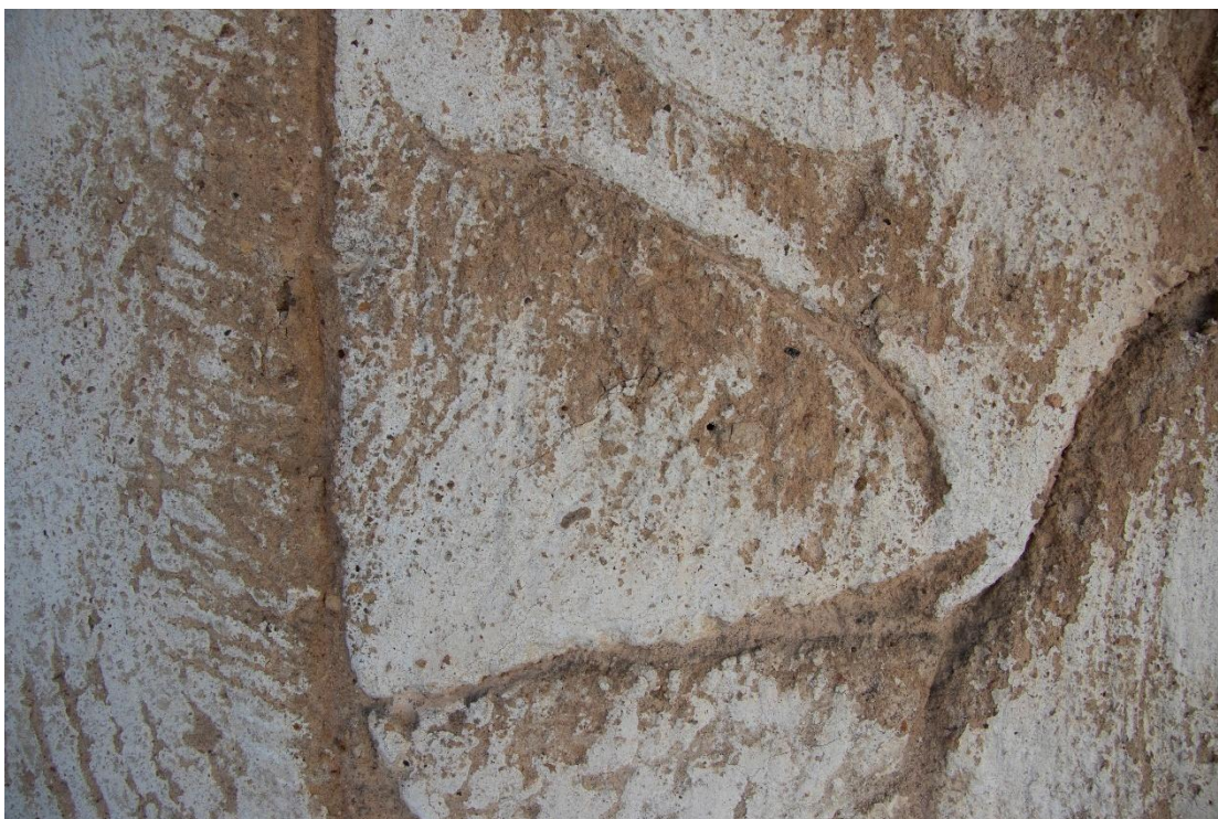
Obr. 4 – Ukázka poškození – duina na rozhraní rekonstrukce z 80. let a původního intonaca, stav před restaurováním, denní světlo.
