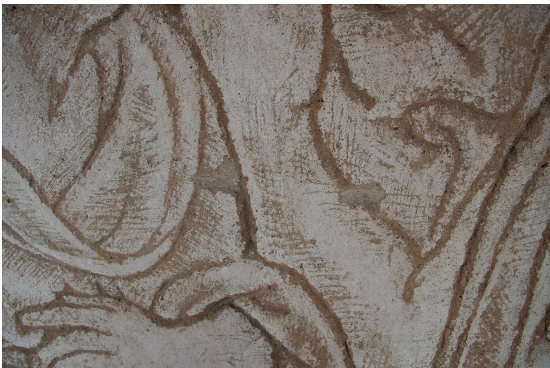
Obr. 5 - Ukázka poškození – odpadlé části intonaca, stav před restaurováním, denní světlo.
