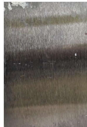
po odstranění nátěru
