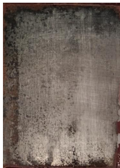
po odstranění nátěru
