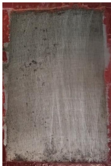
po odstranění nátěru
