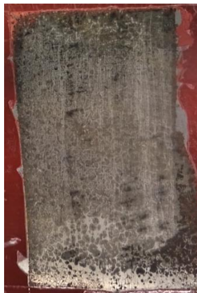
po odstranění nátěru
