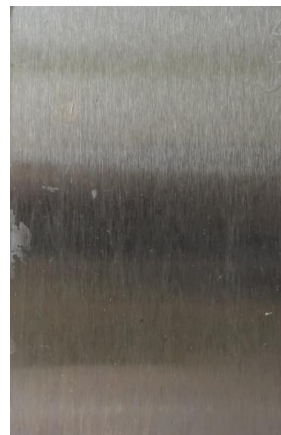
po odstranění nátěru
