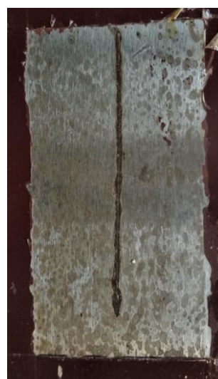
po odstranění nátěru
