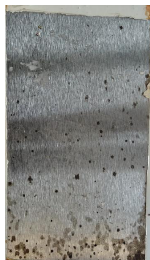
po odstranění nátěru
