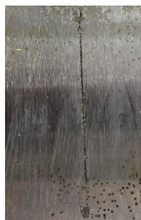
po odstranění nátěru
