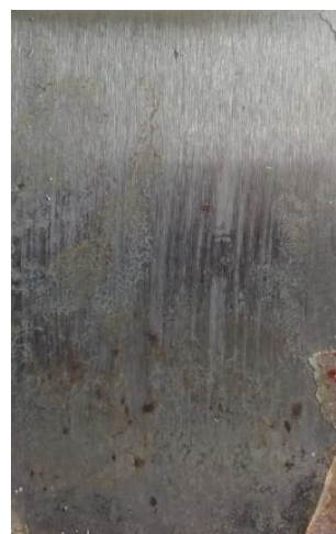
po odstranění nátěru
