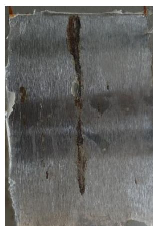
po odstranění nátěru
