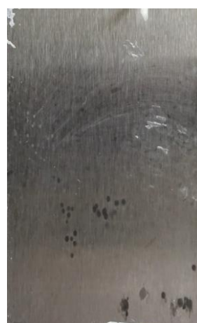
po odstranění nátěru
