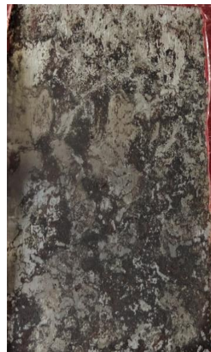
po odstranění nátěru
