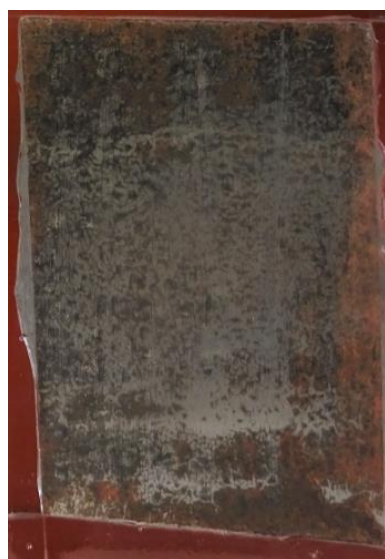
po odstranění nátěru
