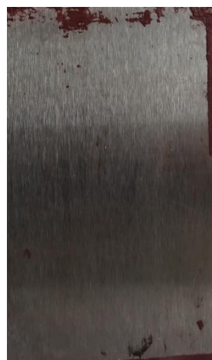
po odstranění nátěru
