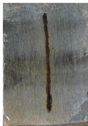
po odstranění nátěru
