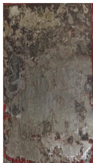
po odstranění nátěru
