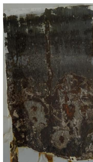
po odstranění nátěru
