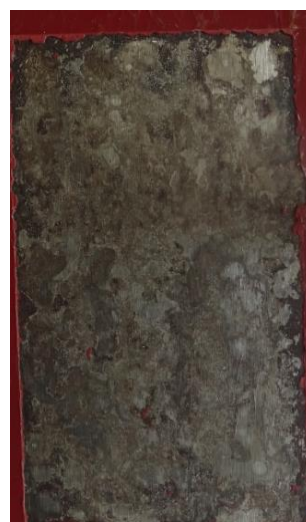
po odstranění nátěru
