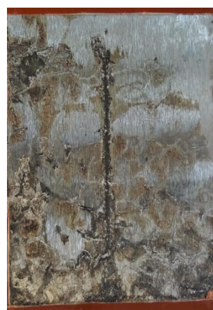
po odstranění nátěru
