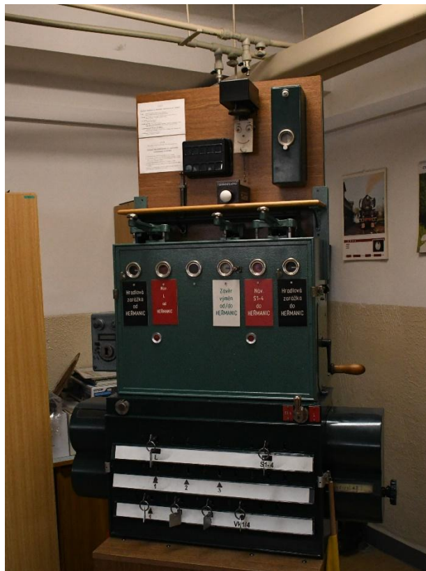
Obrázek 5: Stavědlový přístroj stavědla 1 v ŽST Dřísy
