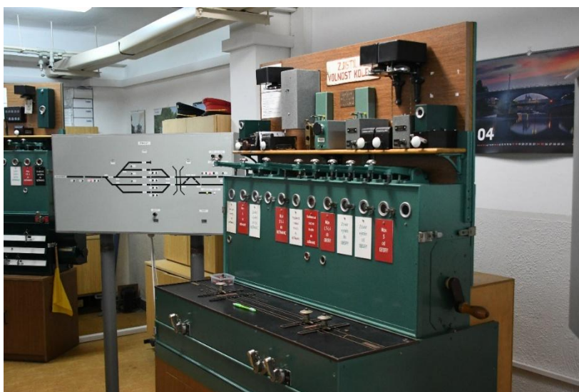
Obrázek 4: Řídicí přístroj elektromechanického zabezpečovacího zařízení v ŽST Dřísy
