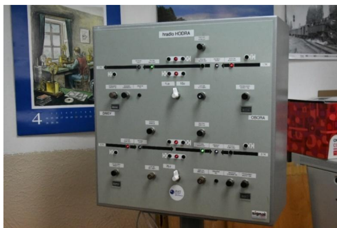
Obrázek 8: Traťové zabezpečovací zařízení hradla Hodrá
