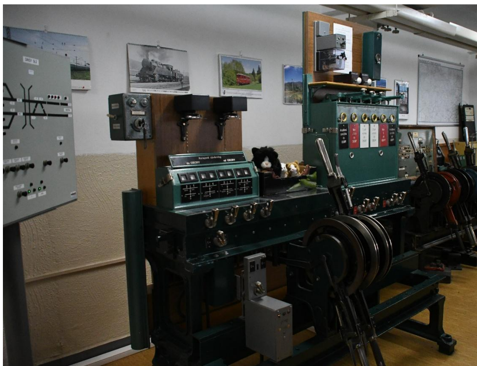
Obrázek 6: Stavědlový přístroj stavědla 2 ŽST Dřísy
