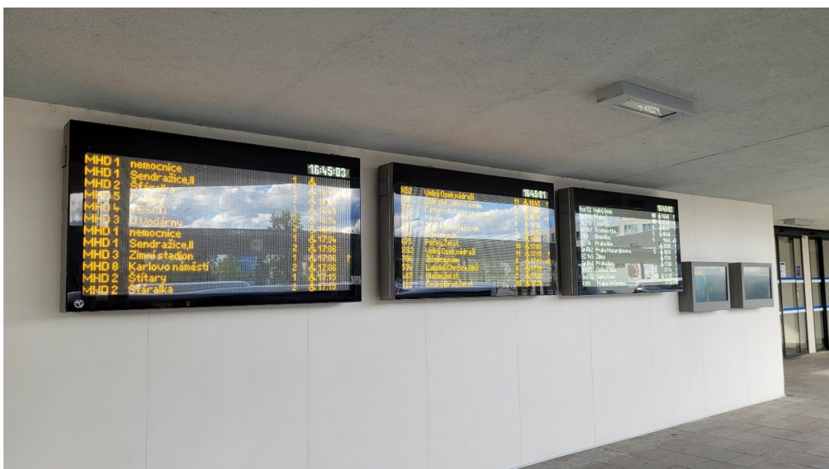
Obrázek 17: Odjezdové informační tabule na fasádě staniční budovy stanice Kolín
