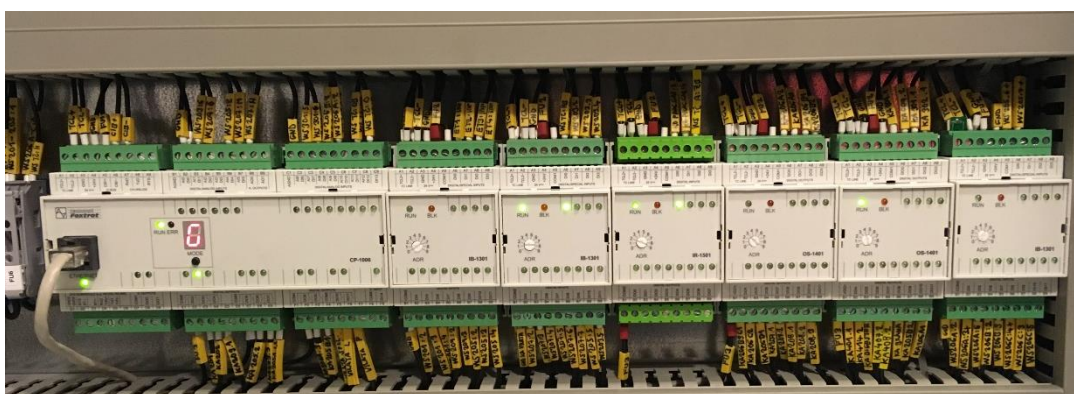
Obrázek 6.1 – Vystavené PLC s rozšiřujícími moduly
