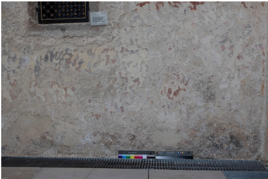
24. Severní stěna presbytáře, východní kout, spodní část – stav po zkouškách zábalů s destilovanou vodou a uhlíčitánem amonným (částečně doschlý stav).
