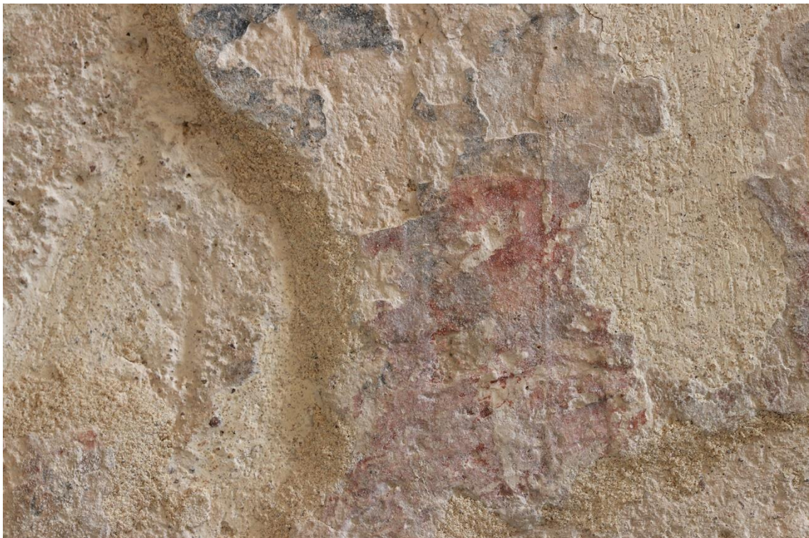
7. Detail barevné vrstvy pokryté zákalem v severní části východní stěny presbytáře.
