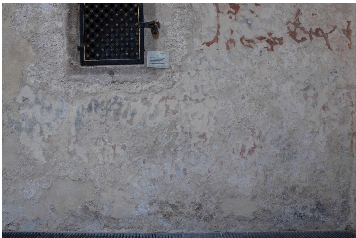
21. Severní stěna presbytáře, východní kout, spodní část – stav před zákrokem.
