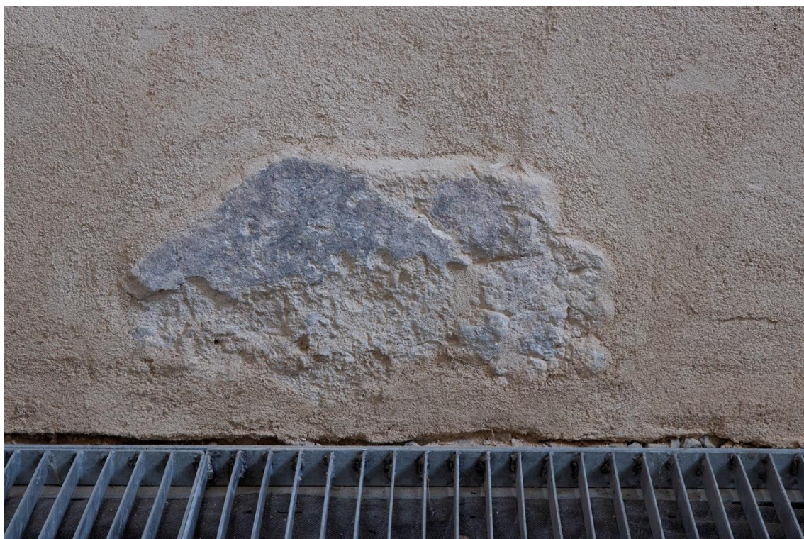
27. Východní stěna presbytáře, severní strana, spodní část – stav před zákrokem.
