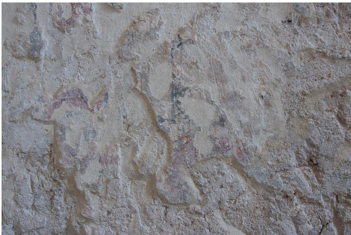
17. Východní stěna presbytáře, severní kout, střední část dolního pásu s postavami – stav před zákrokem.
