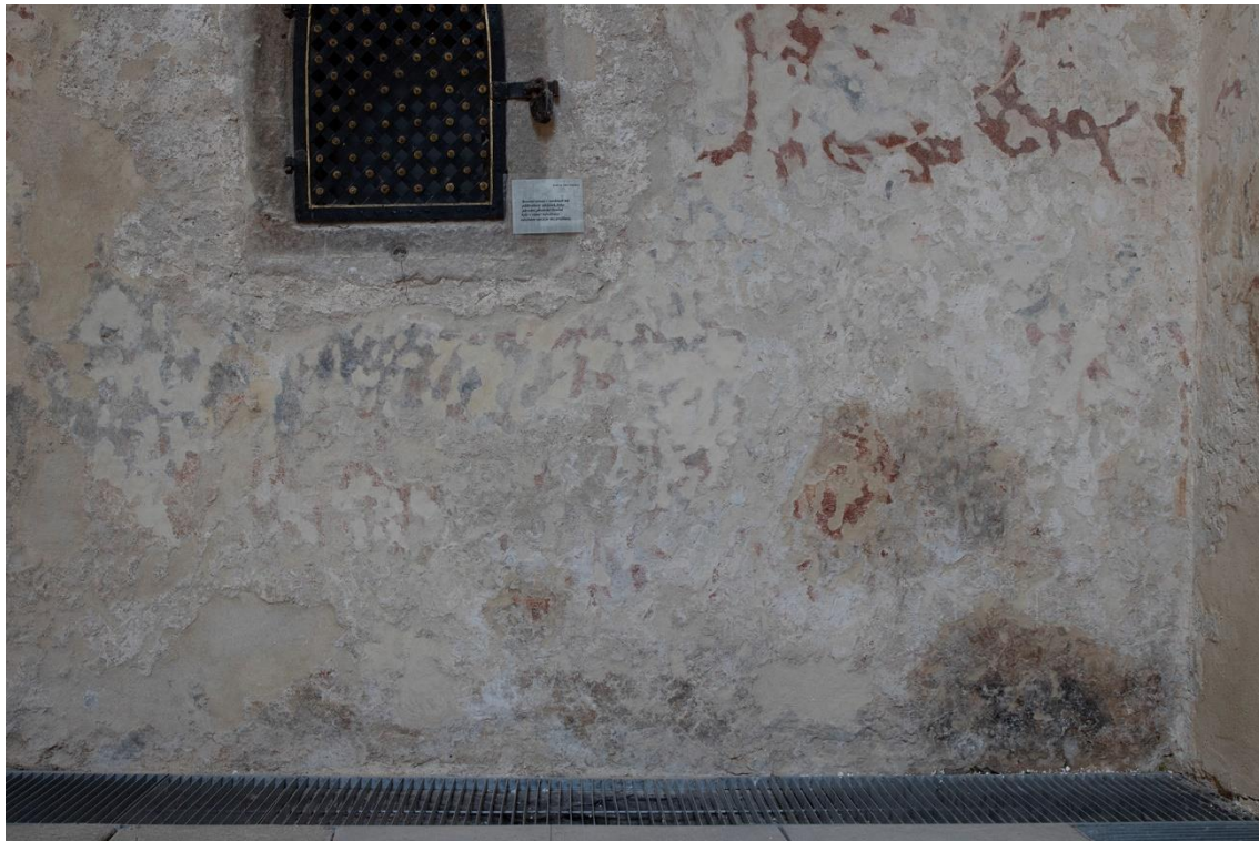
23. Severní stěna presbytáře, východní kout, spodní část – stav po zkouškách zábalů s destilovanou vodou a uhlíčitánem amonným (mokrý stav).
