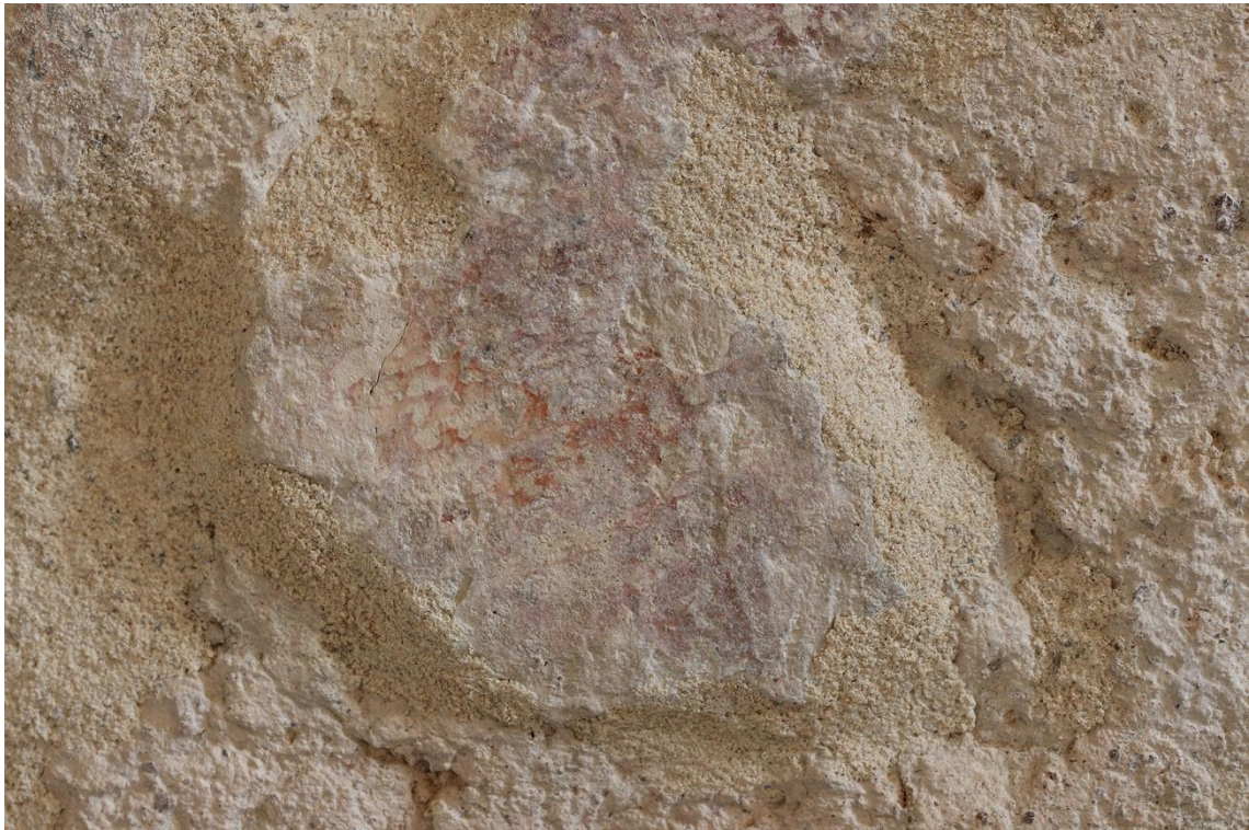
6. Detail barevné vrstvy pokryté zákalem v severní části východní stěny presbytáře.
