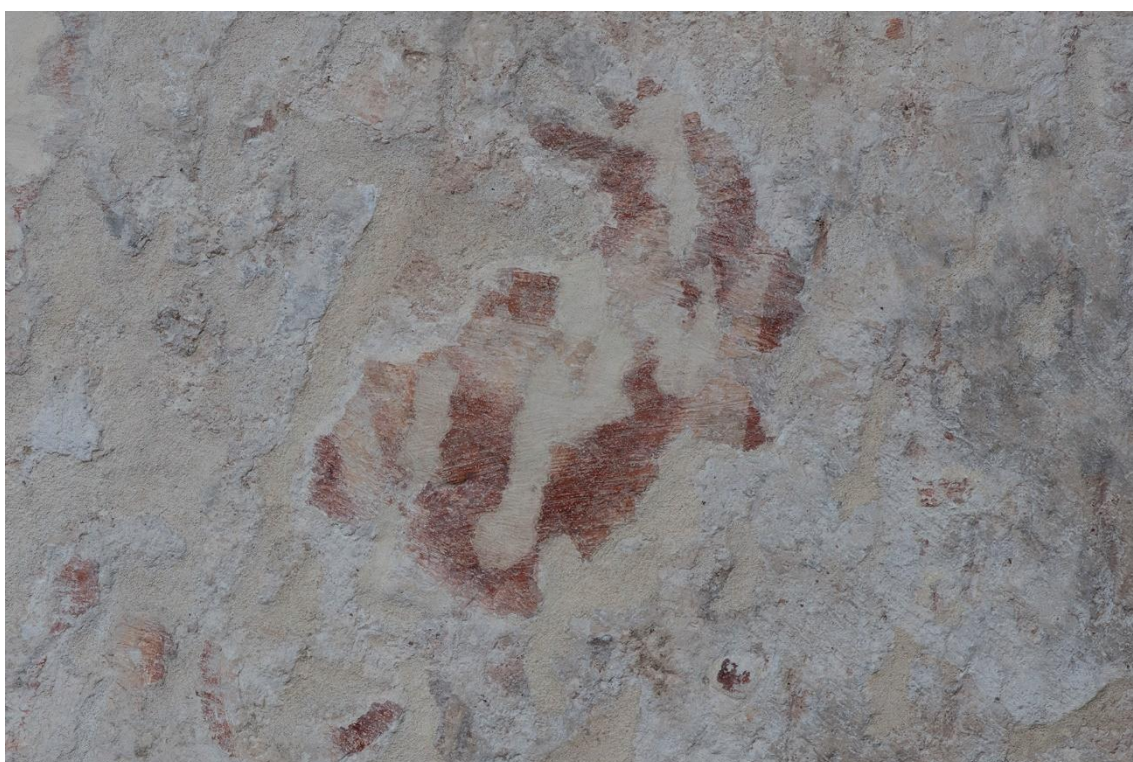
26. Severní stěna presbytáře, východní kout, spodní část – stav po zkoušce retuše ve střední části snímku – detail.
