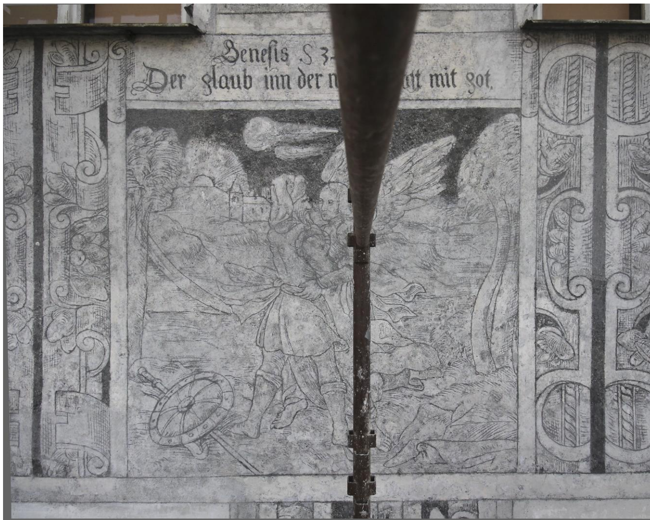
Obr. 71. Stav před restaurováním.
