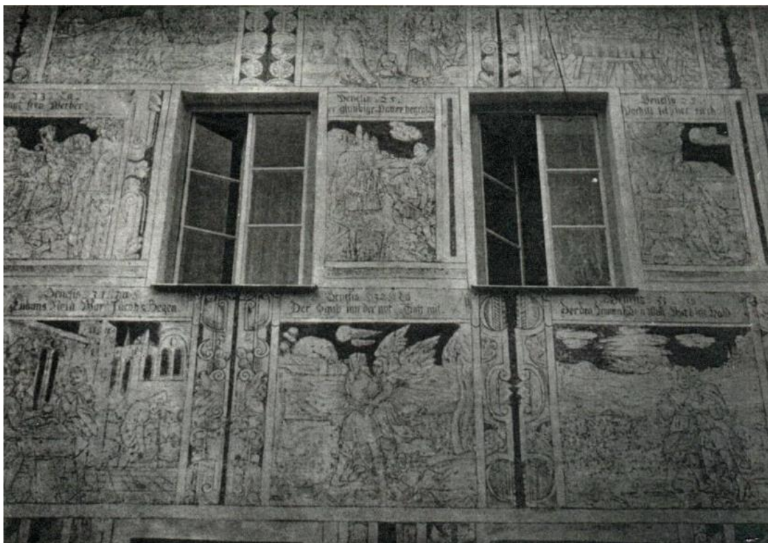
Obr. 9. Fotografie fragmentu fasády ze zásahu v letech 1967-1968, převzata ze článku LEJSKOVÉ-MATYÁŠOVÉ 1970, 18(4č), Autor M. Kolář
