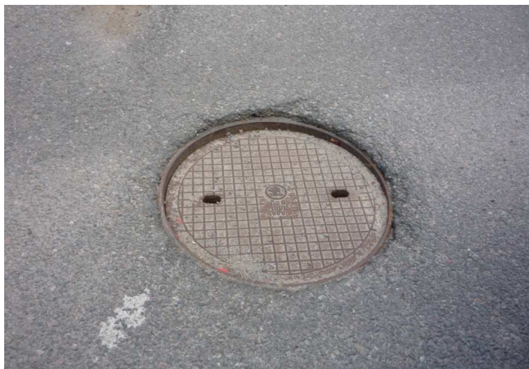
Obr. č. 7 Propadlý kanalizační poklop
