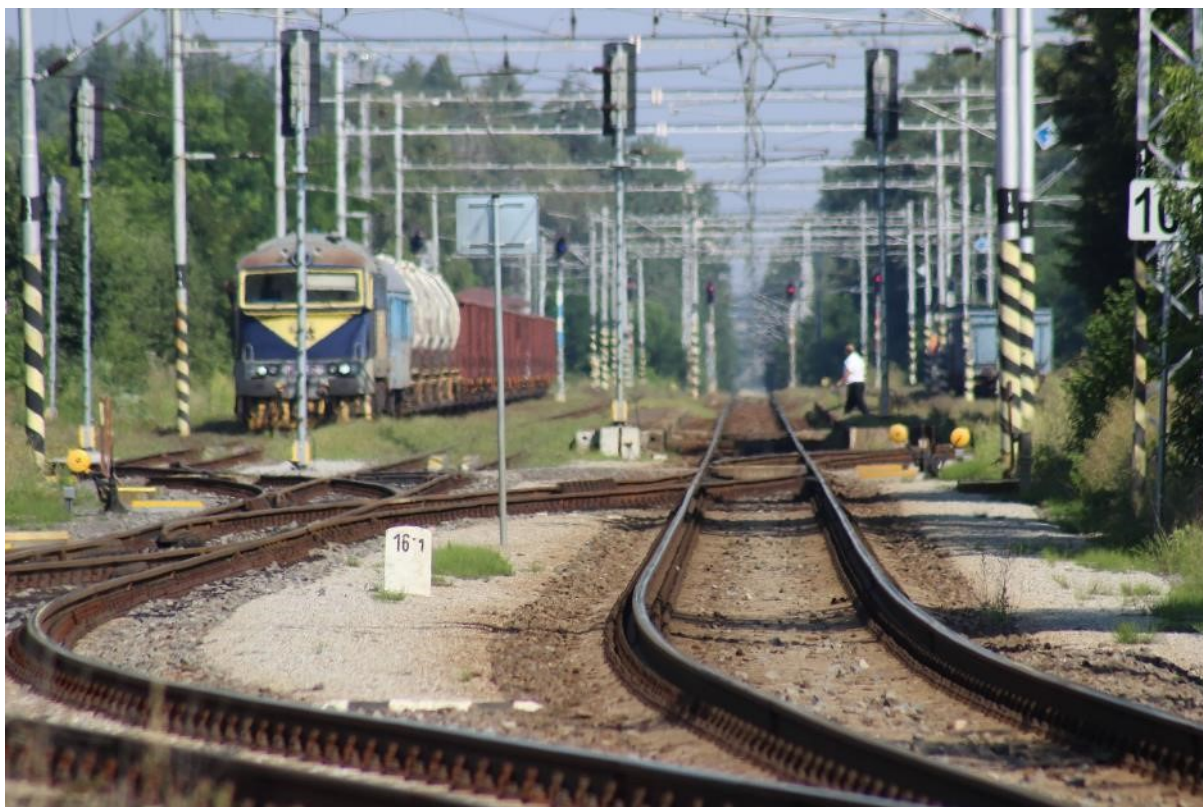
Fotografie 13: Chocenské zhlaví. Za koncem směrového oblouku začíná přímá vedoucí skrz celou železniční stanici. Pohled ve směru staničení.
