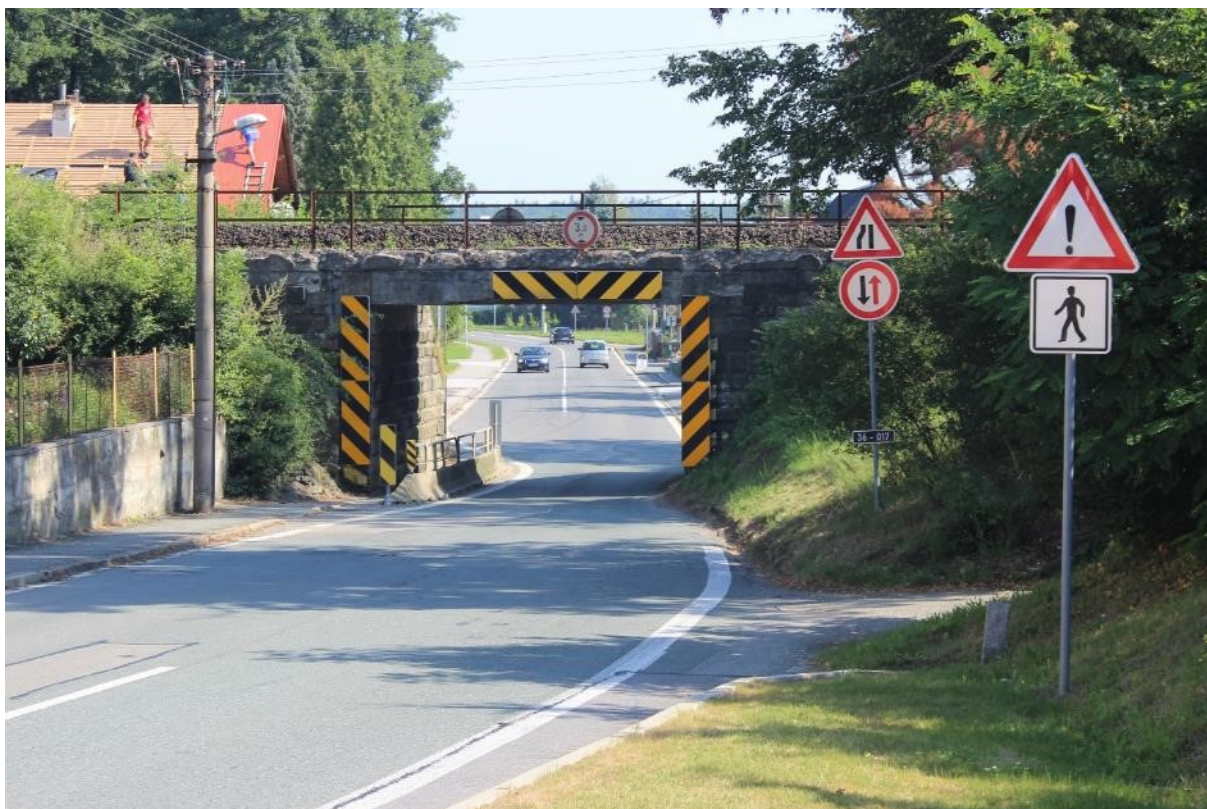
Fotografie 7: Silnice I/36. Volná šířka pod mostem také není vyhovující pro silnici I. třídy.
