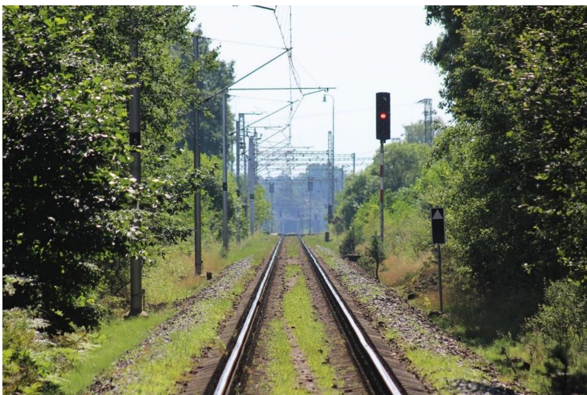
Fotografie 28: Vjezdové návěstidlo S. Pohled proti směru staničení na žst. Borohrádek a vjezdové návěstidlo od Týniště nad Orlicí.
