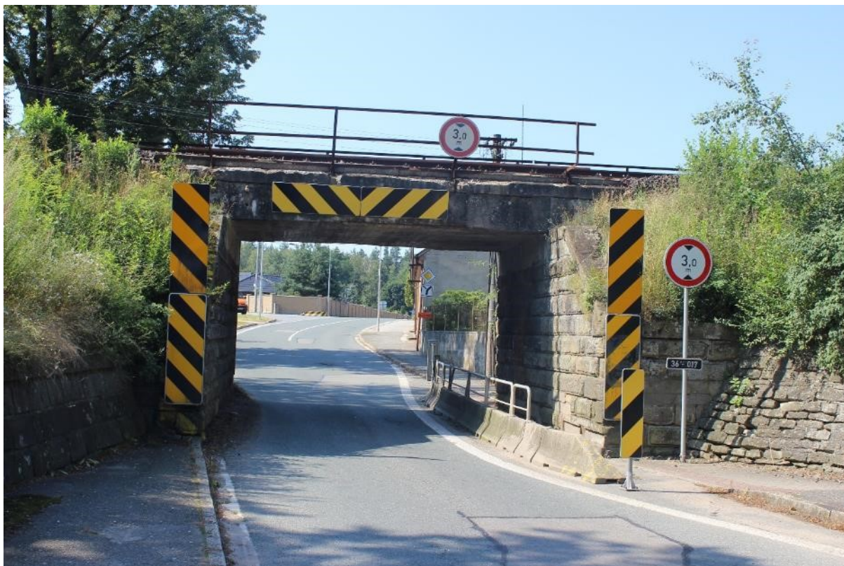
Fotografie 5: Silniční podjezd. Stávající křížení železniční tratě 026 a silnice I/36. Za zmínku stojí také šířka průchodu vyhraněného pro chodce.
