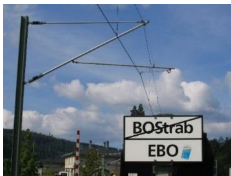
Obrázek 18 Informační návěst pro přechod z tramvajové na železniční trakční soustavu
