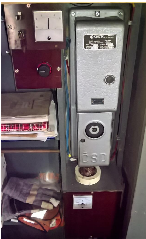
Obrázek 6 - Skříň regulátoru dobíjení (vpravo) a termostat nezávislého topení (vlevo) na stanovišti strojvedoucího v motorovém voze M131.1454. Fotografie: autor práce
