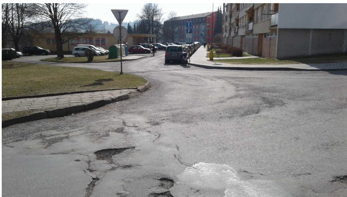
Obrázek 6 – Porušení vozovky, defekty obrubníku
